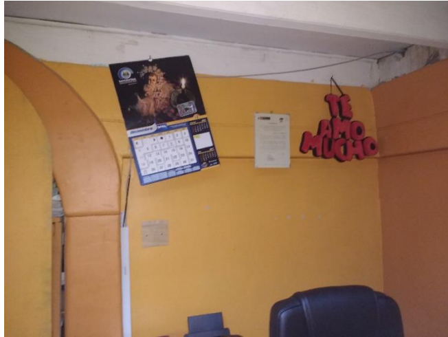
Figura 4.8. Vista del muro el cual presenta fisuras.
