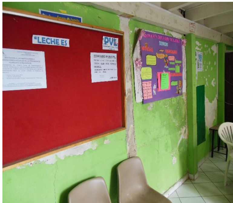
Figura 4.4. Vista del Muro en el cual se presenta las fisuras y grietas
