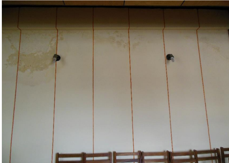
Figura 4.25. Vista de la humedad en los muros.
