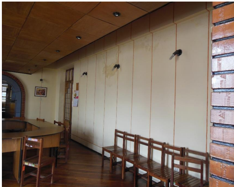
Figura 4.26. Vista de la humedad.
