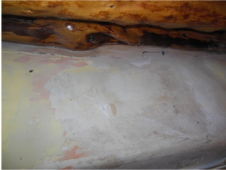
Figura 4.17. Vista de fisura.
