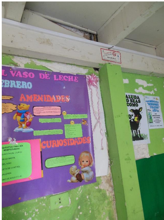
Figura 4.5. vista del techo de madera, presentando fallas
