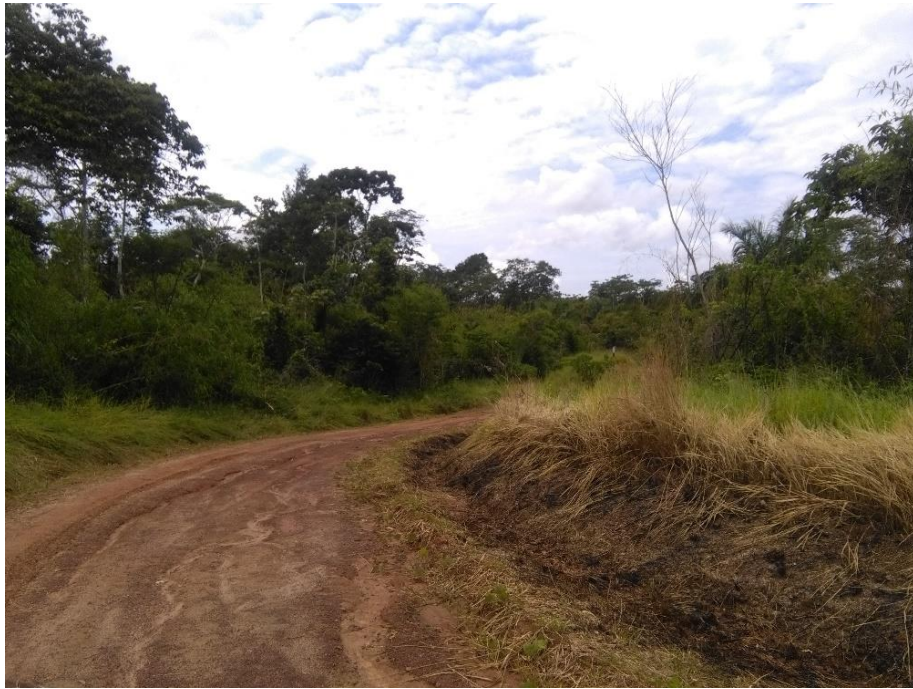
Figura 26: Erosión de la subrasante por escorrentía. Fuente: Propia.
