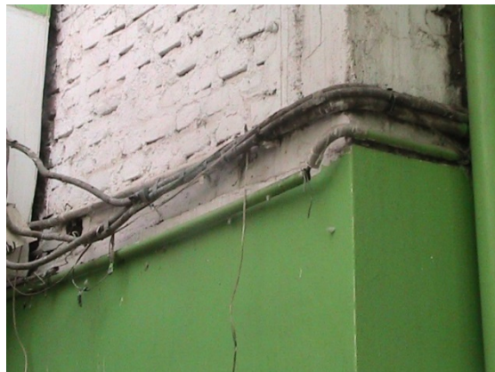
Figura 4.9 Cableado horizontal instalado por pared
