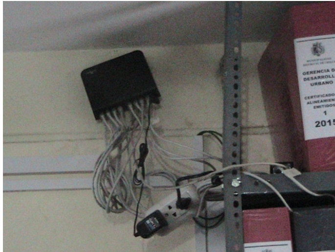
Figura 4.5 swich de 16 puertos a la intemperie Fuente: Red de la MDCH Elaboración: Propia
