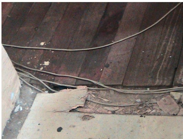
Figura 4.4 Cable de red sueltos por el piso Fuente: Red de la MDCH Elaboración: Propia
