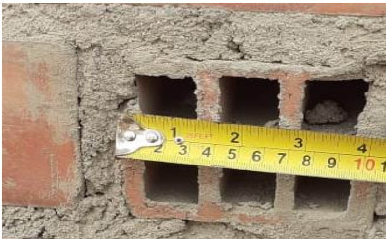
Fotografía 7. Ancho de mortero vertical 2.2 cm
