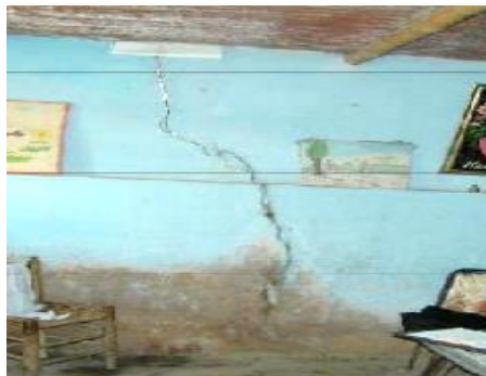
Figura 38. Grietas en muros por asentamiento diferencial
