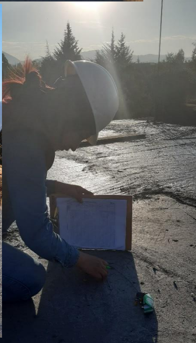
Collage de fotos N° 04: Registro y mapeo de fisuras por retracción plástica.
