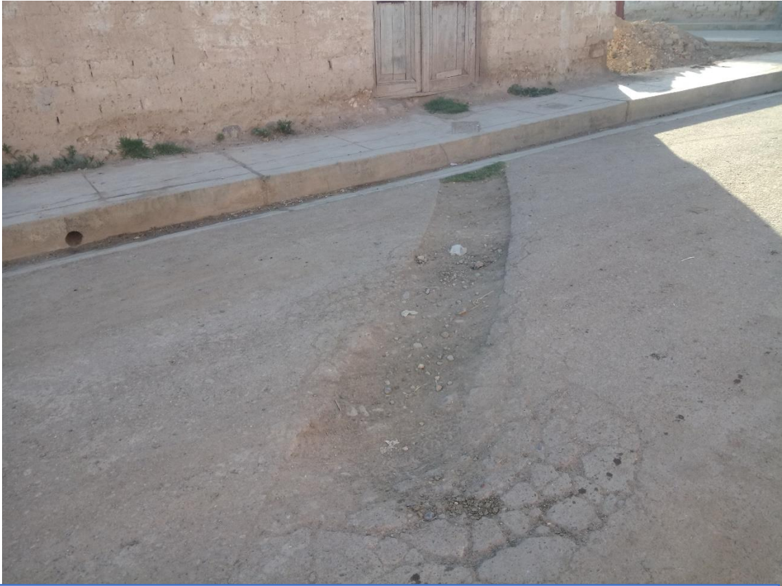
IMAGEN 6: FALLA IDENTIFICADA EN EL JR, ATAHUALPA. PARA REALIZAR LA INSTALACION DE AGUA Y DESAGUE A LA VIVIENDA, SE REALIZO UN CORTE EN EL PAVIMENTO EL CUAL NO FUE RESANADO Y SE PRODUJO EL DETERIORO PIEL DE COCODRILO DE GRAVEDAD MEDIA.
