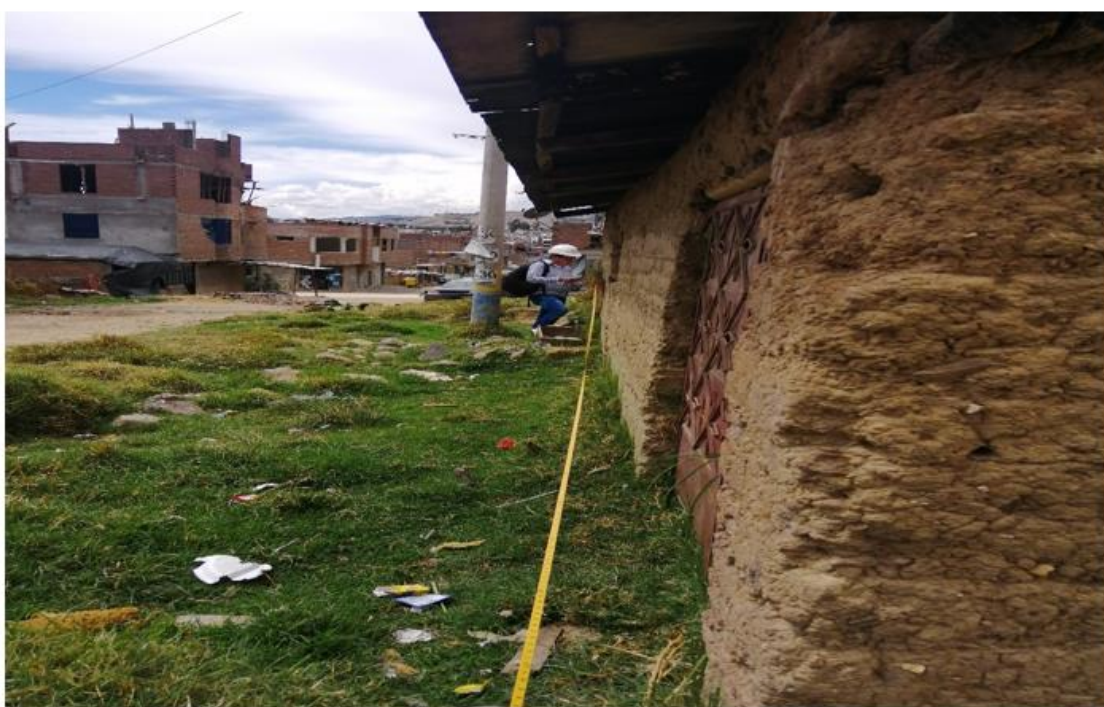
Fotografía 08: Medición del área de las viviendas para el estudio de vulnerabilidad sísmica – Asociación los Libertadores – Huancayo Fuente: Propia.
