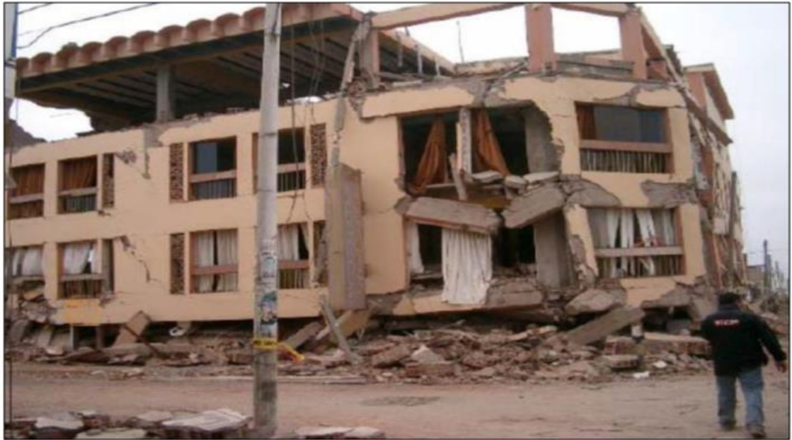
Figura 2. Efecto de piso blando en una edificación. Fuente: Medina & Pimichumo (2018).
