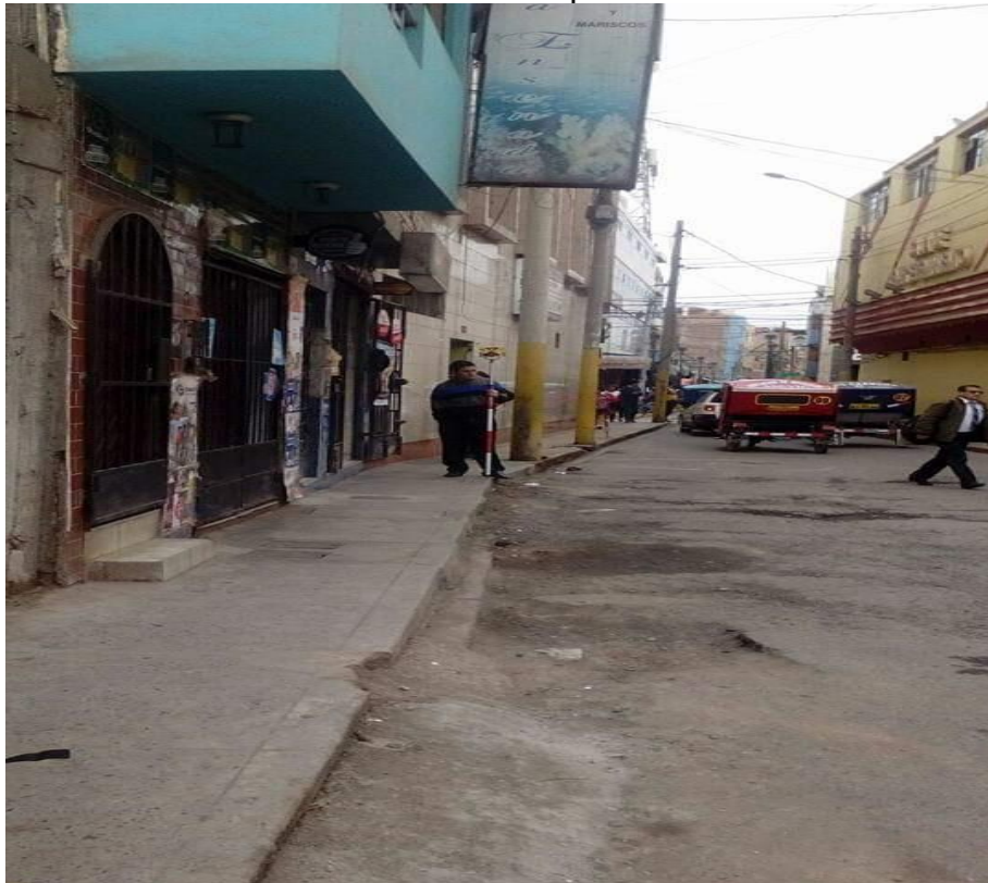
Foto N°02: Vista del Pavimento Flexible Existente de la Calle Animas cuadra 3 Fuente: Propia
