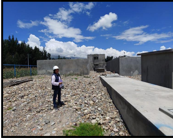
Fotografía 4.- Planta de tratamiento de Aguas residuales N°01
