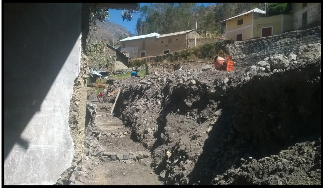
FOTO N° 09: PERFILADO Y CONFORMACION DEL TERRENO PARA LOS CIMIENTOS DEL MURO DE CONTENCIÓN
