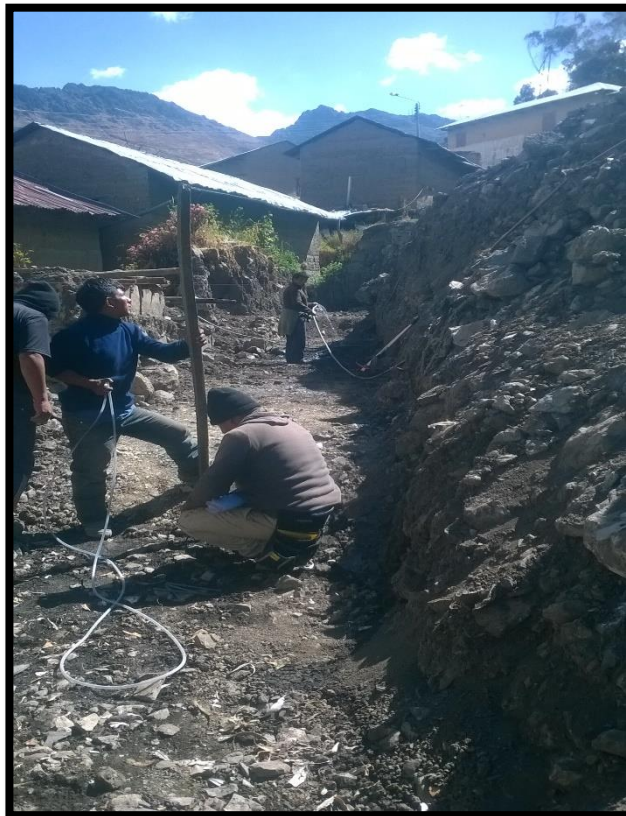
FOTO N° 07 Y N° 08: NIVELACIÓN DEL TERRENO DONDE SE EJECUTARÁ EL PRIMER MURO DE CONTENCIÓN
