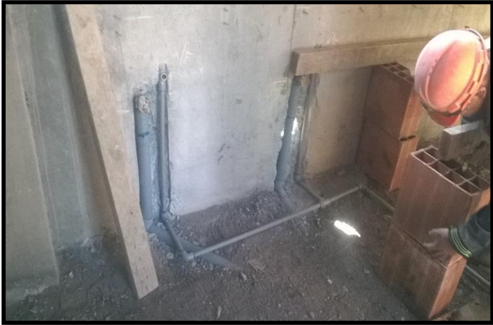
FOTO N° 44: CONEXIONES DE AGUA EN LOS AMBIENTES DE LOS SS.HH. Y CAFETIN
