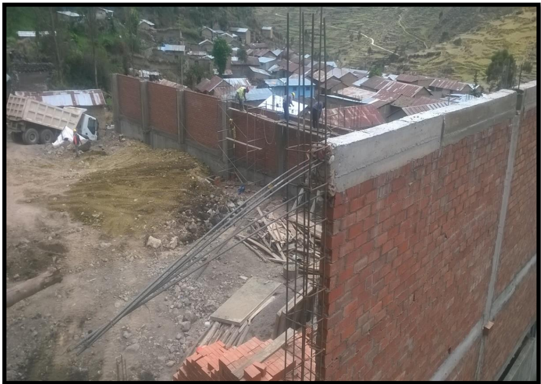
FOTO N°37: CONTINUACIÓN DE LA VIGA DE AMARRE DEL SEGUNDO TRAMO DEL EJE A-A'
