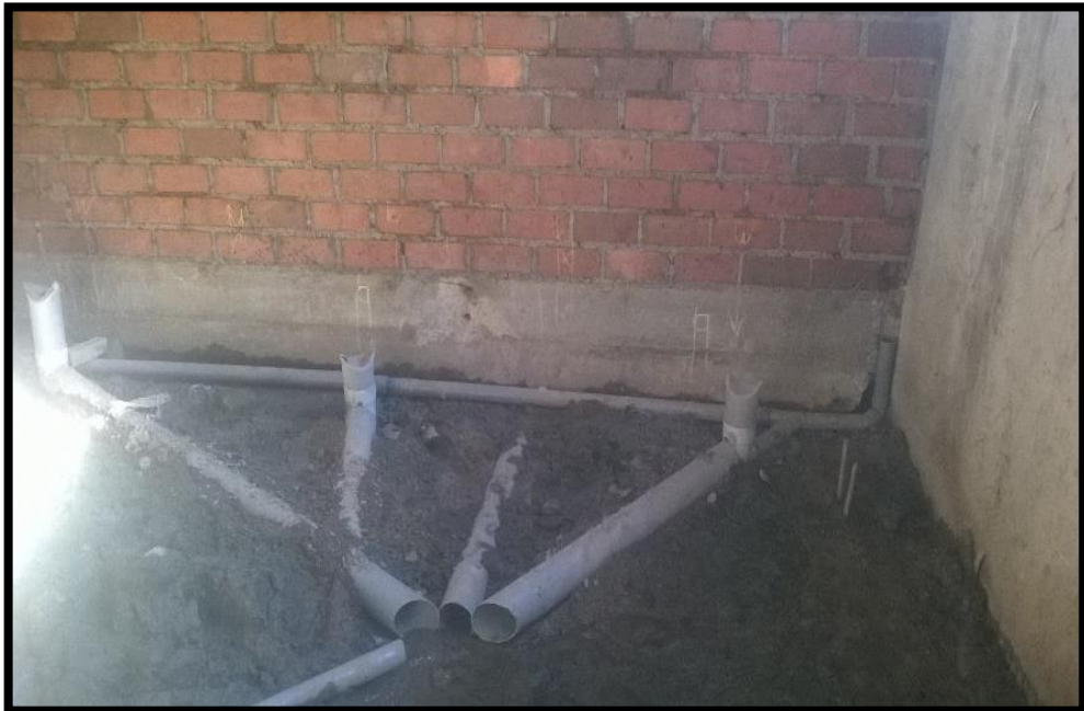
FOTO N° 45: CONEXIONES DE DESAGUE EN LOS AMBIENTES DE LOS SS.HH. Y CAFETIN
