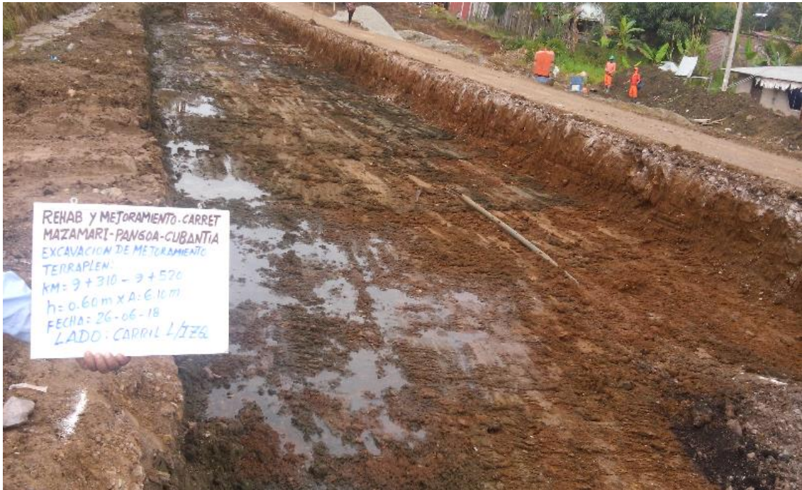
Figura N° 03: Mejoramiento, filtración de agua (Nivel freático).
