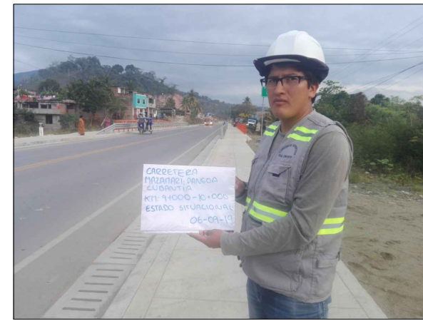
ESTADO SITUACIONAL (06/09/19) PAVIEMTO FLEXIBLE KM 9+400
