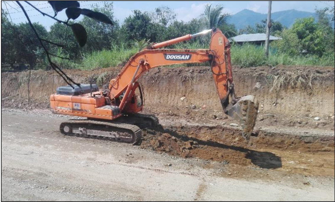
Figura N° 11: Corrección de tramo observado por presentar deflexiones altas km 9+500.
