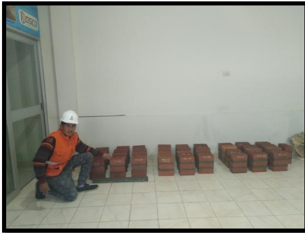
Figura N° 23 Una vez concluido el asentado de pilas se procedió guardarlos en un ambiente cerrado con ventilación según indica la norma.
