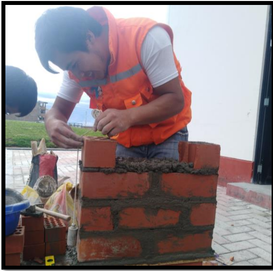
Figura N° 25 Para controlar la verticalidad de los muretes de albañilería se utilizó una plomada y la verticalidad se controló con un nivel de mano.
