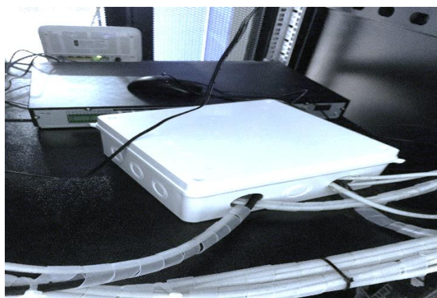
Figura 18. Ubicación de DVR, balun, conectores Fuente: Elaboración propia.
