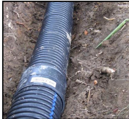
Figura 19: Tubería HDPE 6" Corrugada.
