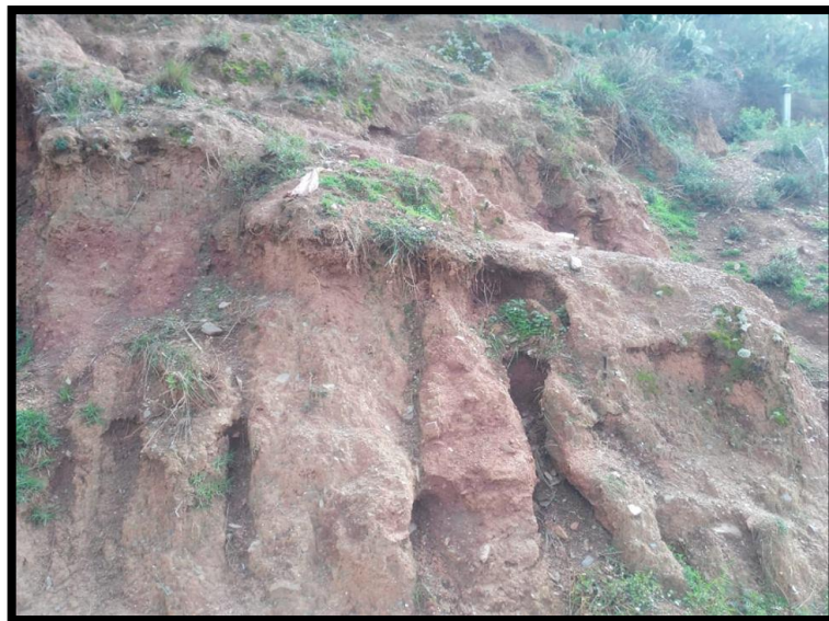
La fotografía muestra la erosión del suelo a causa del escurrimiento de agua.
