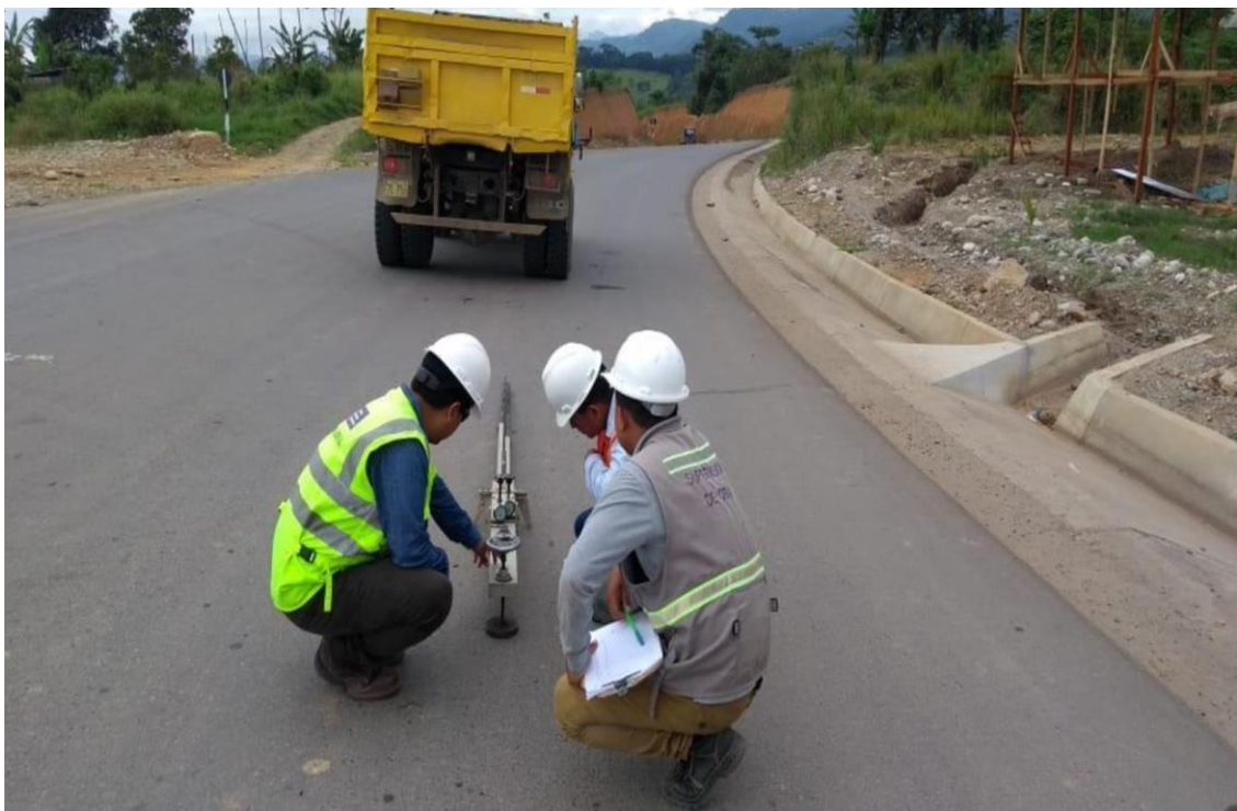
Figura N° 30: Deflectometría a nivel de carpeta asfáltica Km 2+000 – 3+000 plataforma completa.
