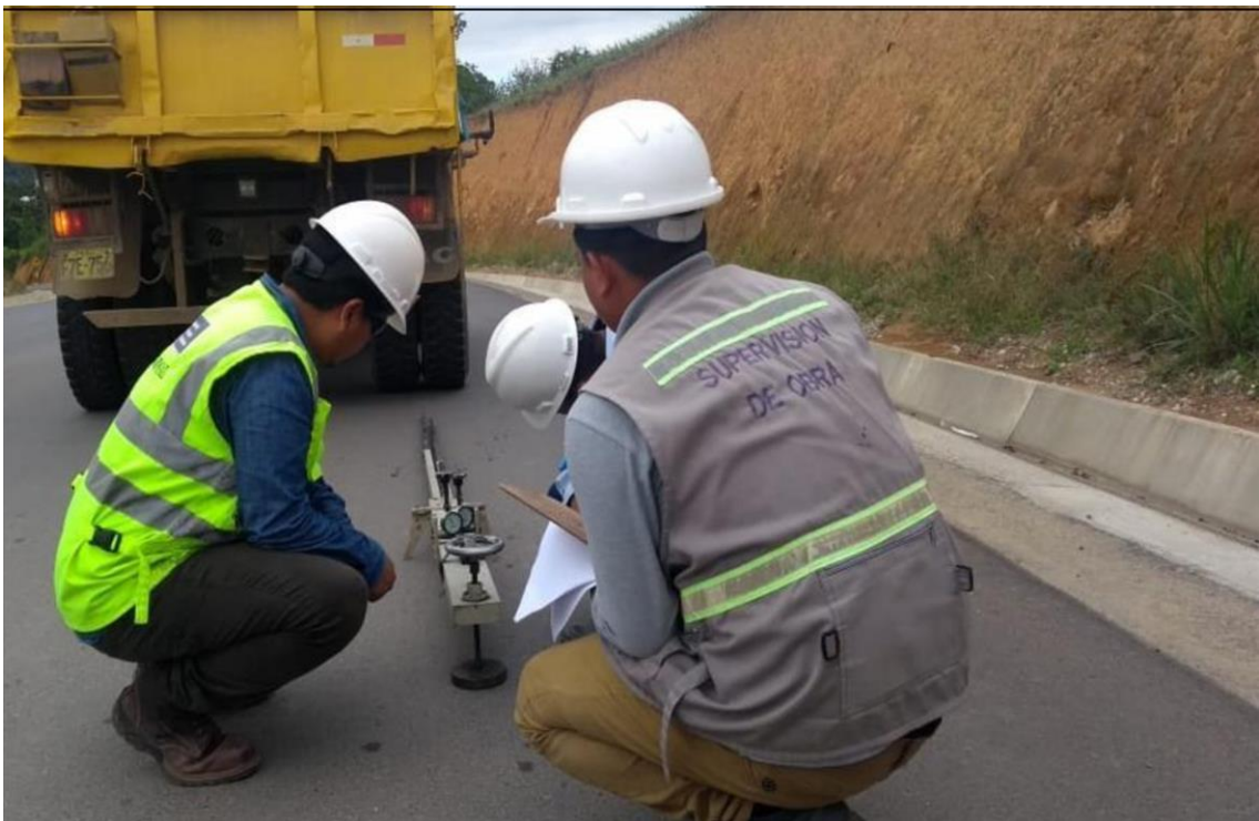
Figura N° 29: Deflectometría a nivel de carpeta asfáltica Km 2+000 – 3+000 Plataforma completa.
