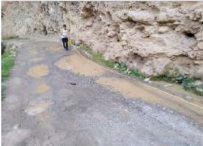
Foto 091: Lodazal en la progresiva 15+280
