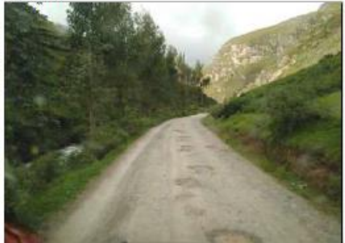
Foto 092: Baches en la progresiva 15+540
