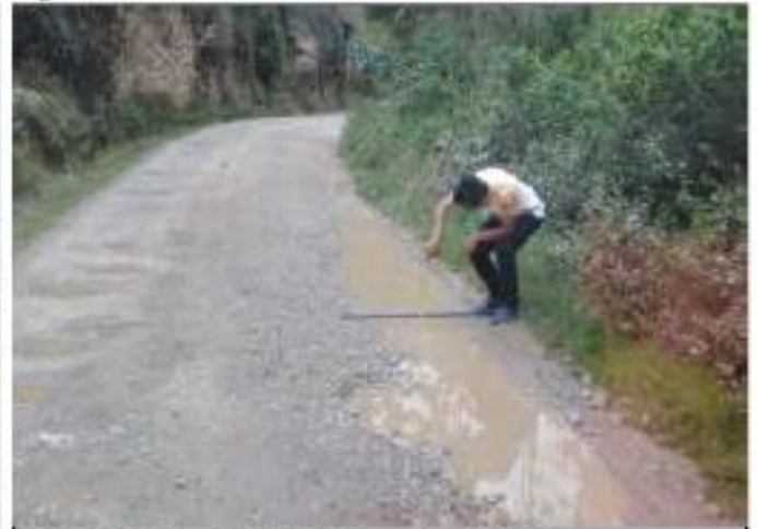
Foto 080: lodazal 10.70 x1.20 m; Km: 14+000
