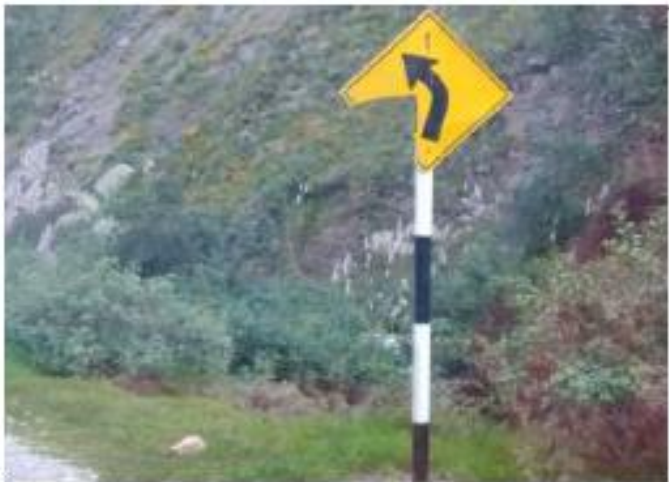
Foto 027: Señal Preventiva en mal estado 4+390
