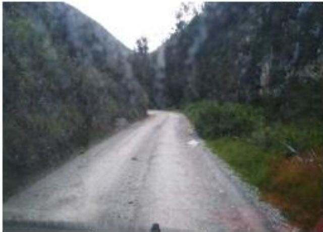
Foto 013: Erosión a lo largo de la vía hasta la progresiva 5+000 aproximadamente
