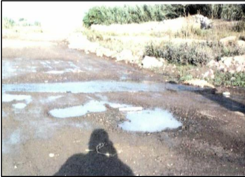
Figura 10: Necesita una reconstrucción
