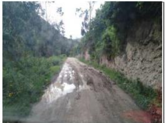
Foto 060: Lodazal 10x1.5m en la progresiva 11+430
