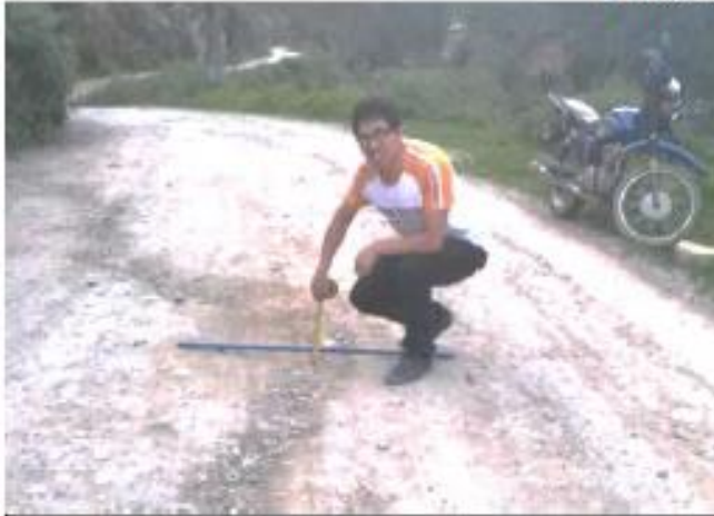
foto 007: Erosión en la vía desde progresiva 1+000 - 5+000
