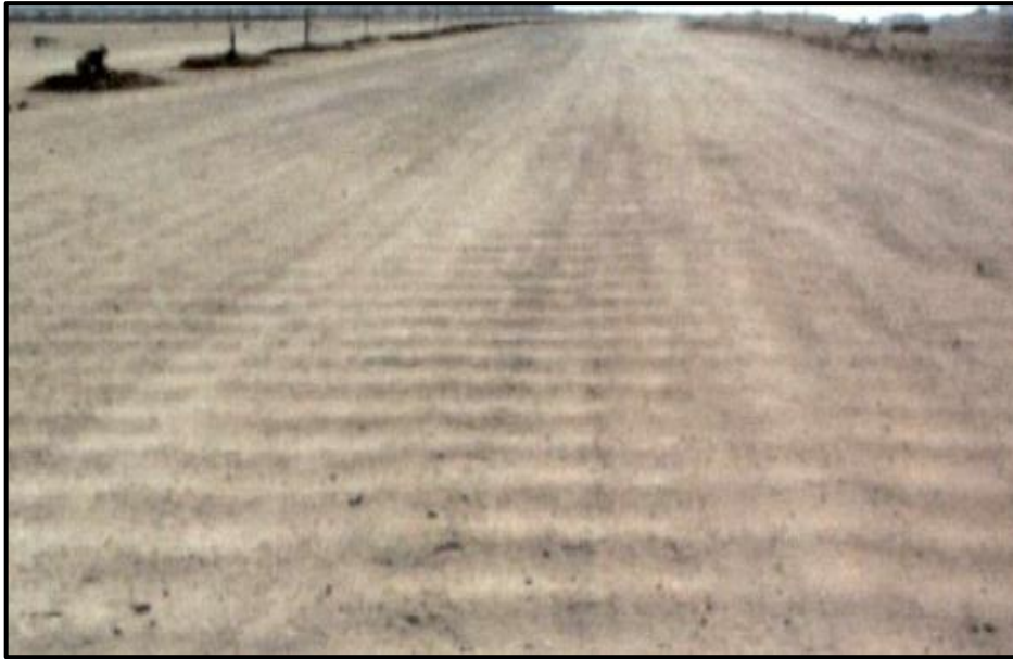
Figura 11: Perceptibles al usuario, pero < 5 cm Fuente: "Manual de carreteras Mantenimiento o Conservación vial 2018"
