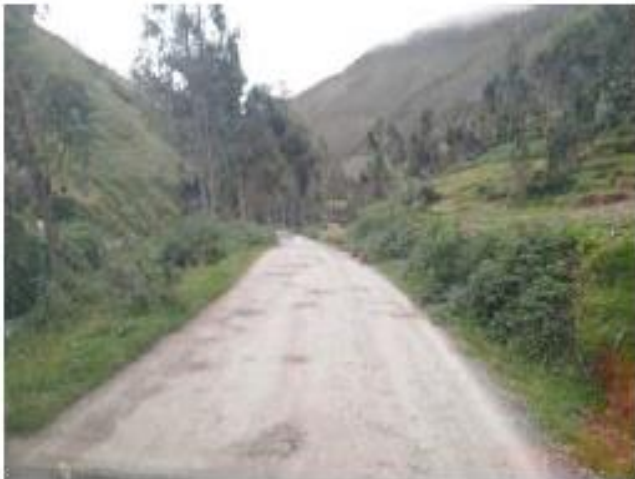
Foto 063: Baches en la progresiva 11+930
