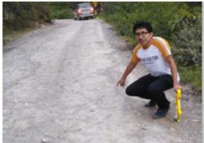
foto 022: Erosión en la vía
