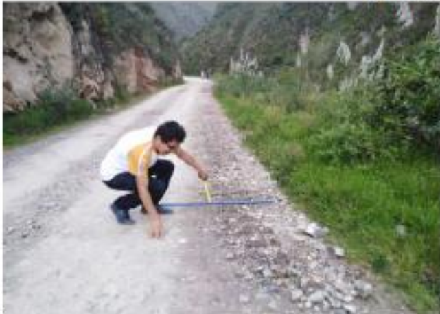
Foto 037: Erosión en la vía de la progresiva 6+500-7+000
