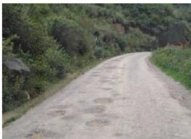
Foto 076: baches en la progresiva 13+800
