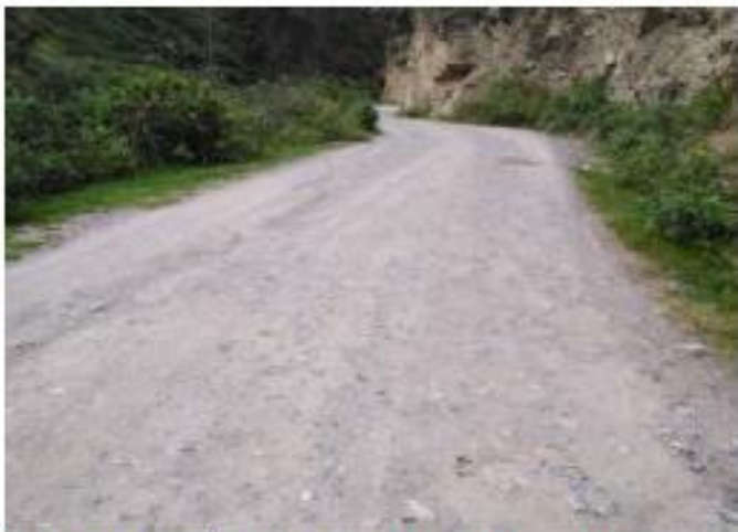
Foto 095: Erosión en la progresiva 15+660-15+840
