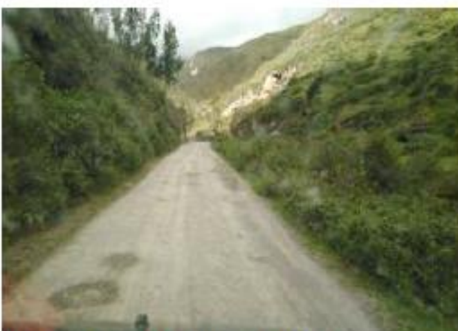
Foto 088: Baches en la progresiva 14+700
