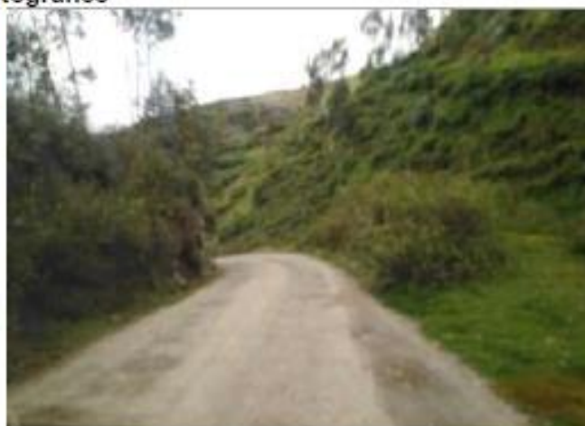
Foto 074: Baches en la progresiva 13+620
