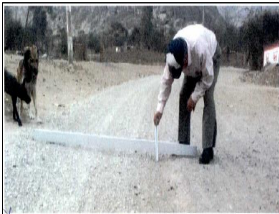
Figura 3: Huellas / hundimientos de 5 cm a 10 cm Fuente: "Manual de carreteras Mantenimiento o Conservación vial 2018"
