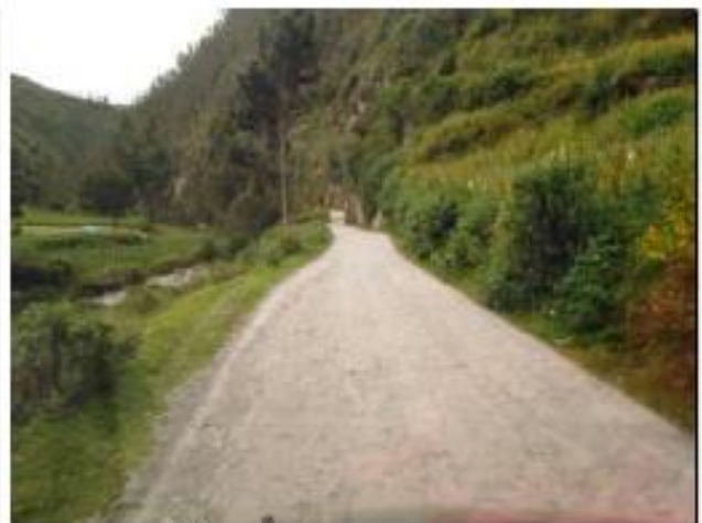
Foto 058: Erosión en la vía 11+080-11+350
