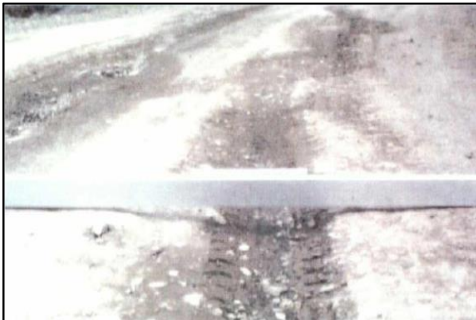
Figura 6: Profundidad entre 5 cm y 10 cm Fuente: "Manual de carreteras Mantenimiento o Conservación vial 2018"
