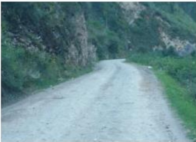
Foto 033: Erosión en la vía 5+500 - 6+000
