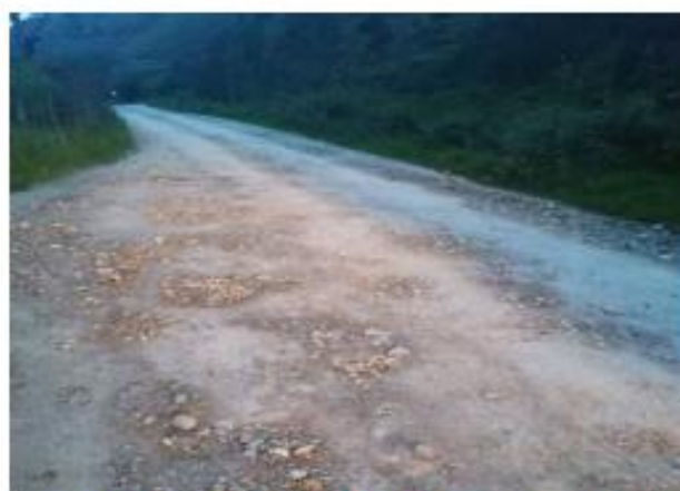
Foto 010: Erosión en la vía desde la progresiva 0+530-1+000
