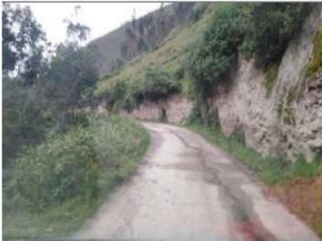
Foto 061: Erosión en la vía 11+450-11+700
