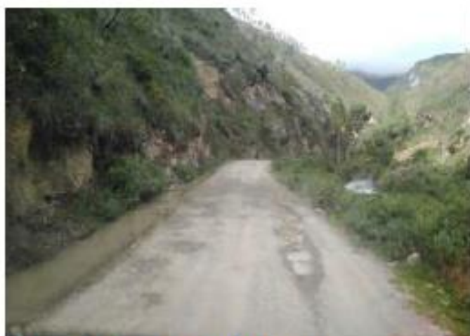
Foto 087: Baches en la progresiva 14+640
