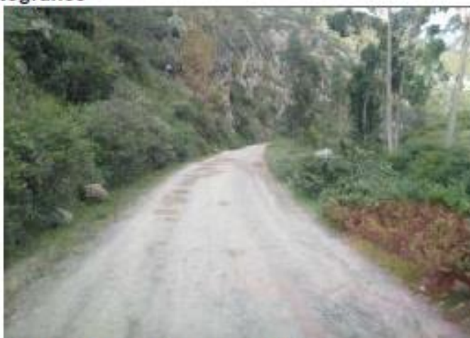
Foto 086: Baches en la progresiva 14+500
