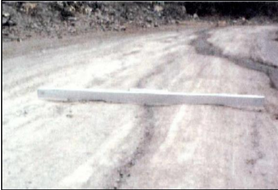
Figura 5: Perceptibles al usuario, pero < 5 cm Fuente: "Manual de carreteras Mantenimiento o Conservación vial 2018".
