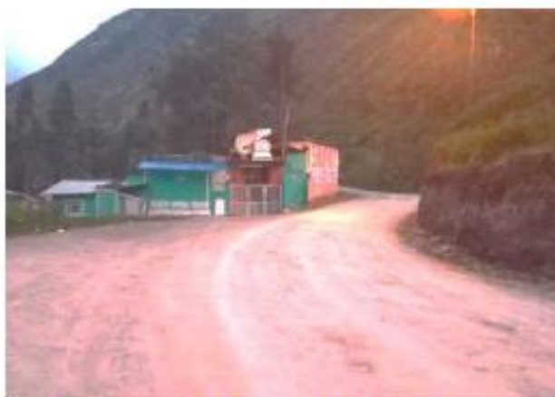
foto 003: Baches en la progresiva 0+430 - 0+530
