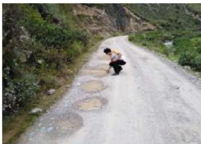
Foto 089: Baches en la progresiva 14+980
