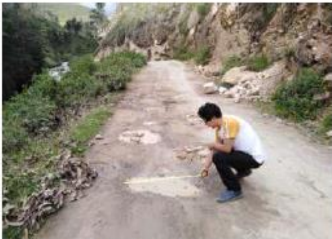
Foto 093: Baches en la progresiva 15+600
