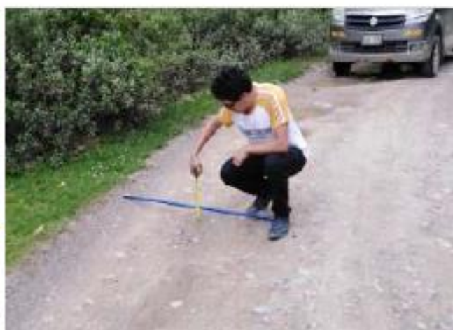
Foto 078: Ahuellamiento en la progresiva 13+880
