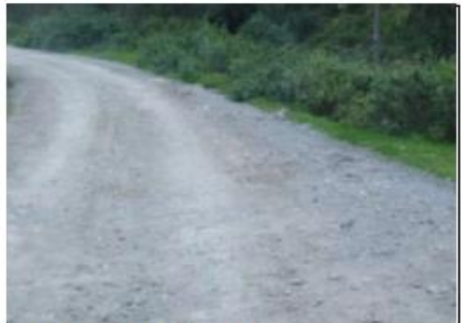
foto 040: Erosión en la vía de la progresiva 7+100-7+300
