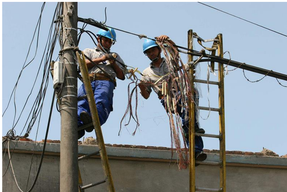
FOTO 01: Instalaciones Banda Ancha
