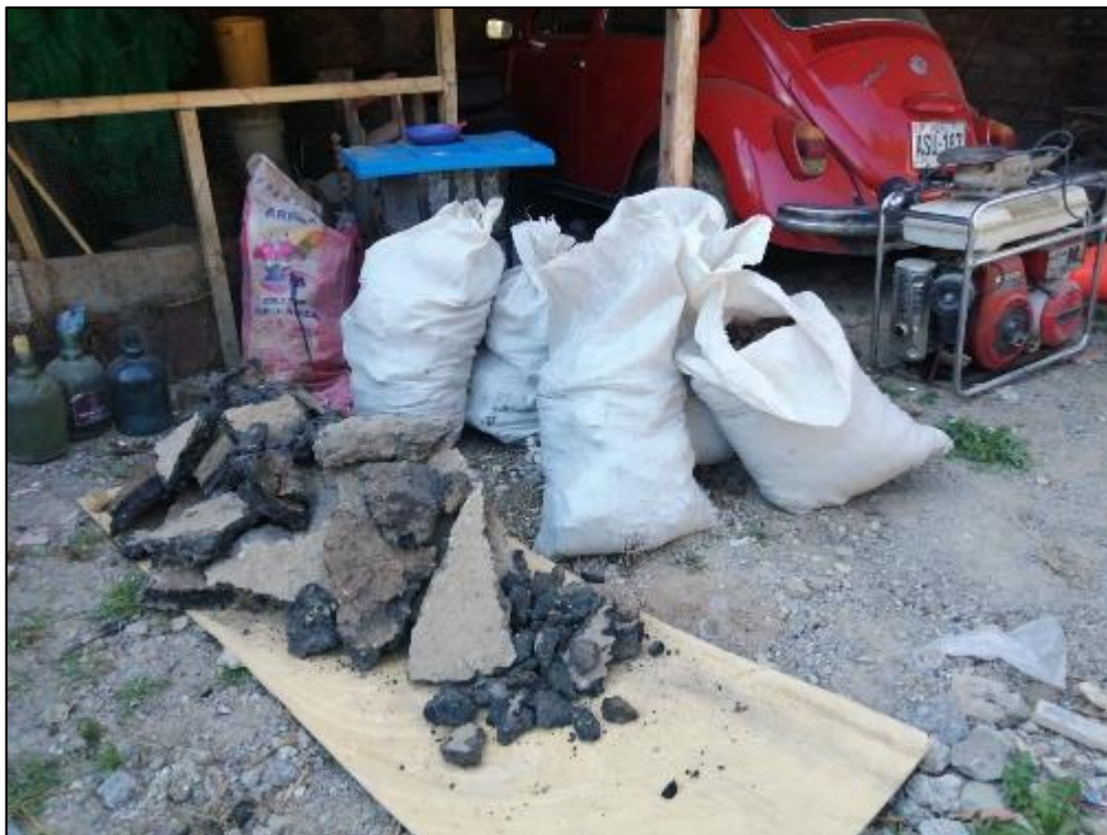
Fotografía 8. Vista de las muestras extraídas tanto de base granular y carpeta asfáltica.
