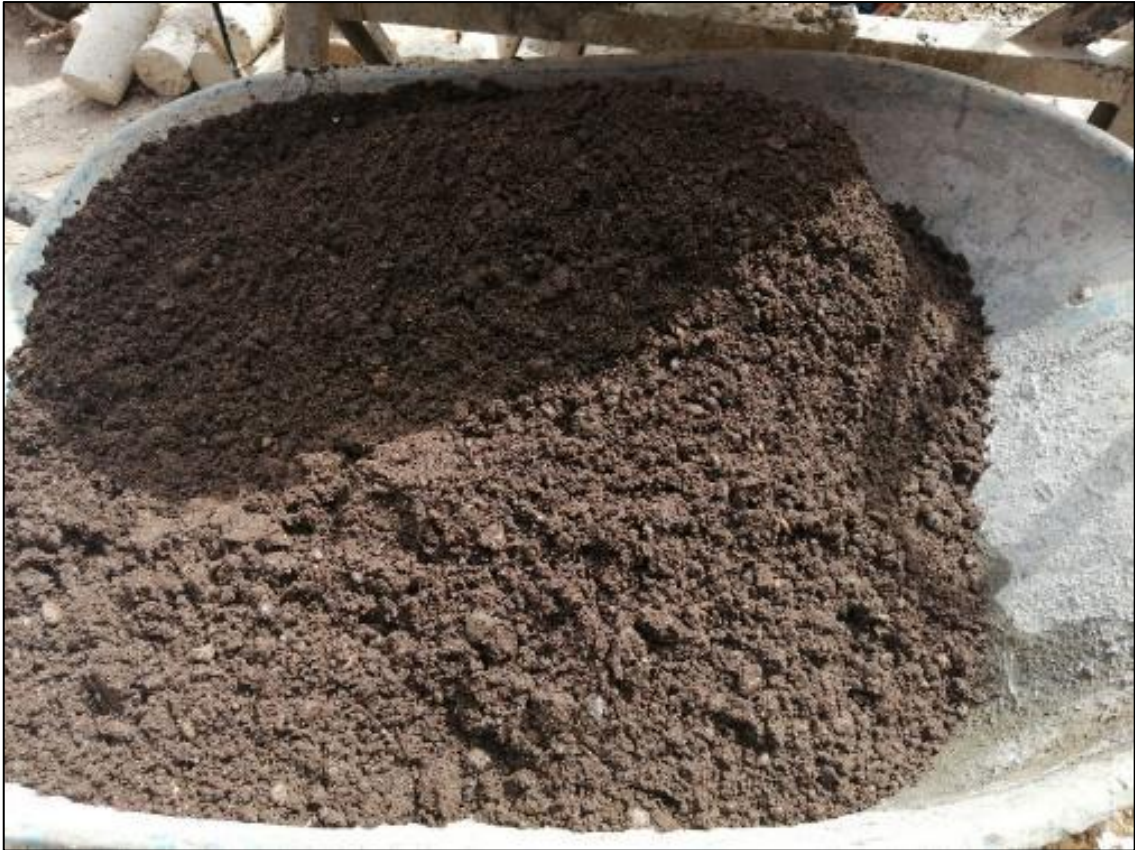
Fotografía 9. Base granular deteriorada.
