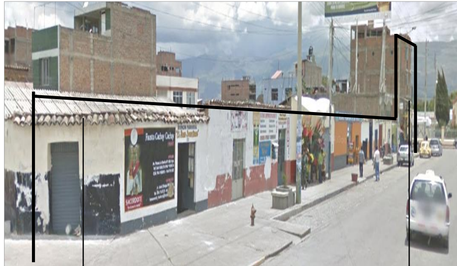
EDIFICACIONES EN MAL ESTADO
