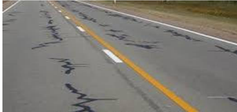
Figura 17. Imagen de Fisuramiento Longitudinal
