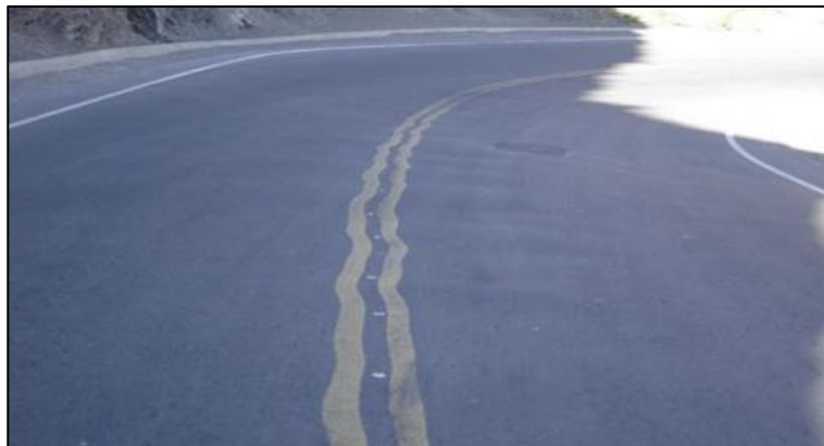
Figura 15. Imagen de Baches en una Carretera
