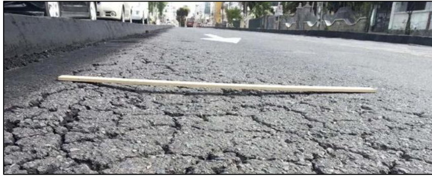
Figura 10. Imagen de desniveles en pavimentos
