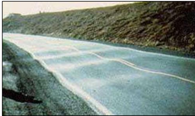
Figura 16. Imagen de Hinchamiento de un Pavimento
