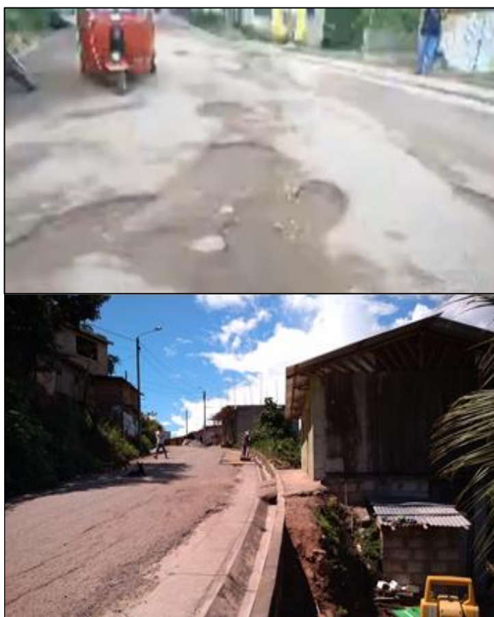
Figuras 20: Fallas de ahuellamiento y baches
