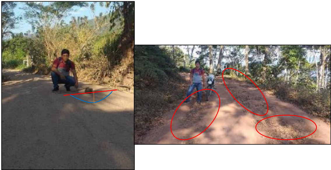
Figuras 04: Falla por deformación o deflexión de la plataforma (Ahuellamientos).
