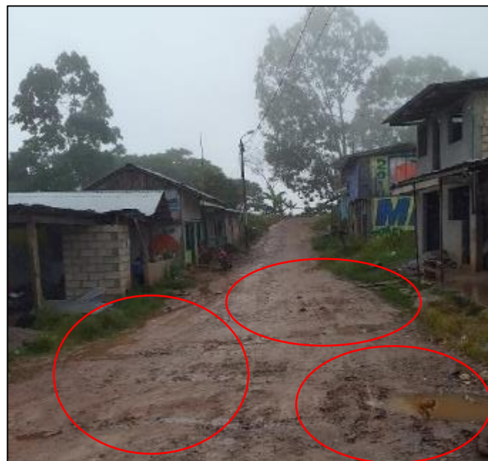
Figura 05: Falla por deformación o deflexión de la plataforma (Baches).
