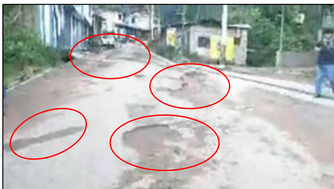
Figura 01: Pavimento flexible en estado de deterioro – fallas por baches y ahuellamiento.
