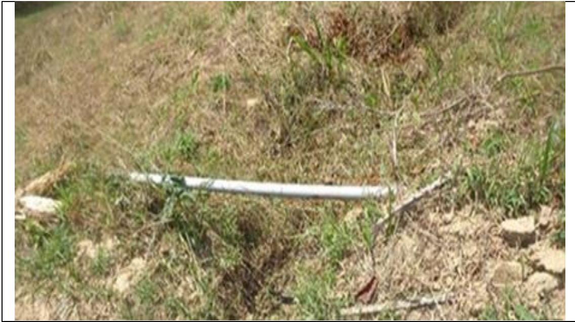
Identificación de las tuberías
