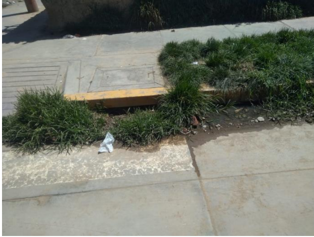
Imagen 54: Presencia de grass en las cámaras de captación
