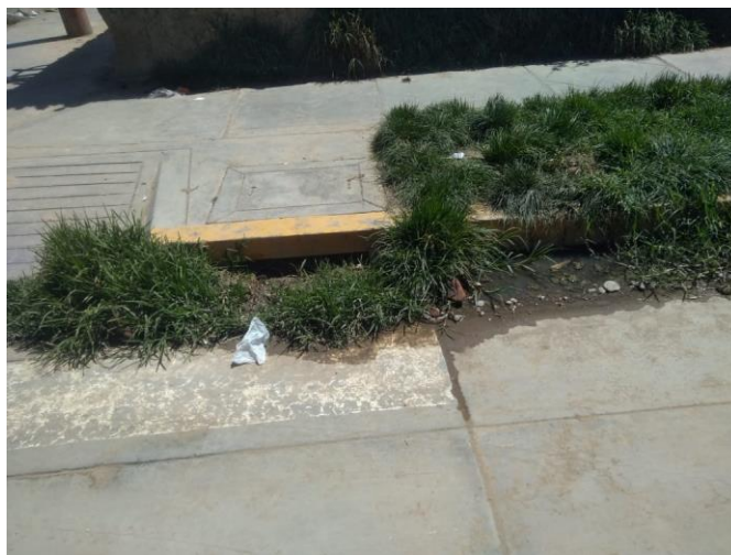
Imagen 39: Obstrucción del canal a base de Grass Jirón Basadre-Jirón Toledo.
