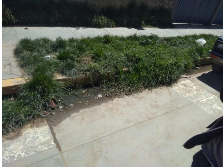
Imagen 40: Cuneta con presencia de grass en el Jirón Basadre
