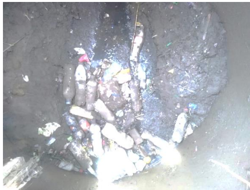
Imagen 52: Falta de mantenimiento y limpieza
