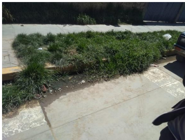
Imagen 53: Presencia de grass que obstruye el paso de aguas de lluvia
