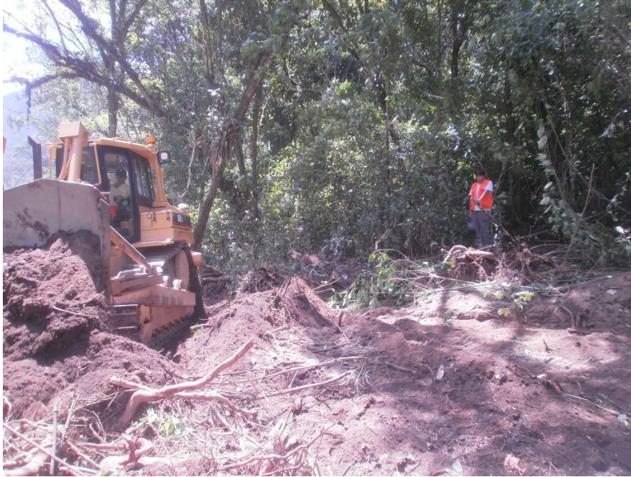
FOTOGRAFIA N° 13: Movimiento de tierras sin la protección de sus EPPS
