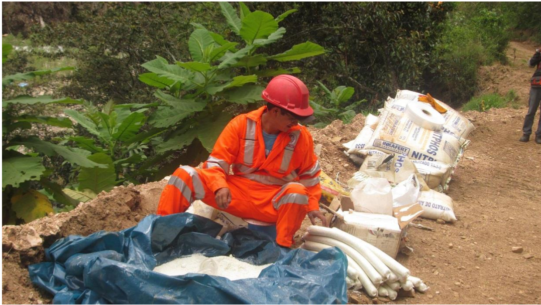
FOTOGRAFIA N° 15: Elaboración del explosivo sin a supervisión de un personal capacitado, ambiente inadecuado, sin EPPS.
