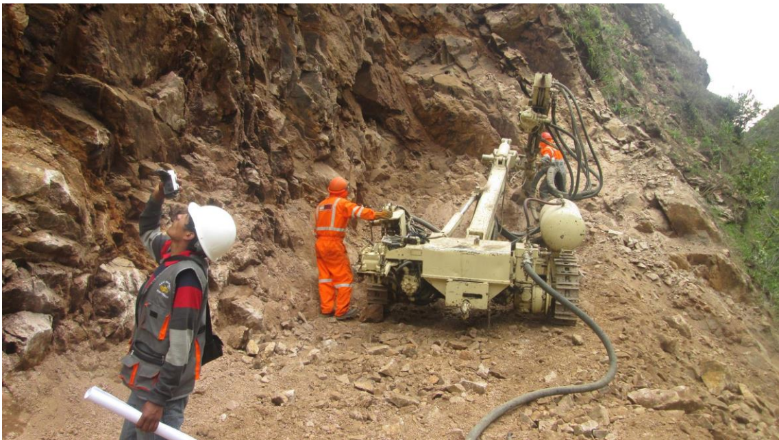
FOTOGRAFIA N° 20: trabajos inadecuados sin los adecuados sostenimientos de rocas propensos a caída de rocas, deslizamiento del talud, entre otros.
