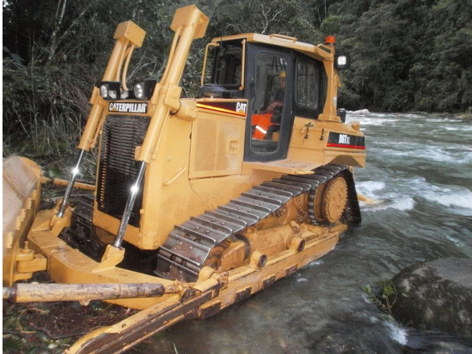
FOTOGRAFIA N° 23: Maniobras imprudentes por causa del operador.
