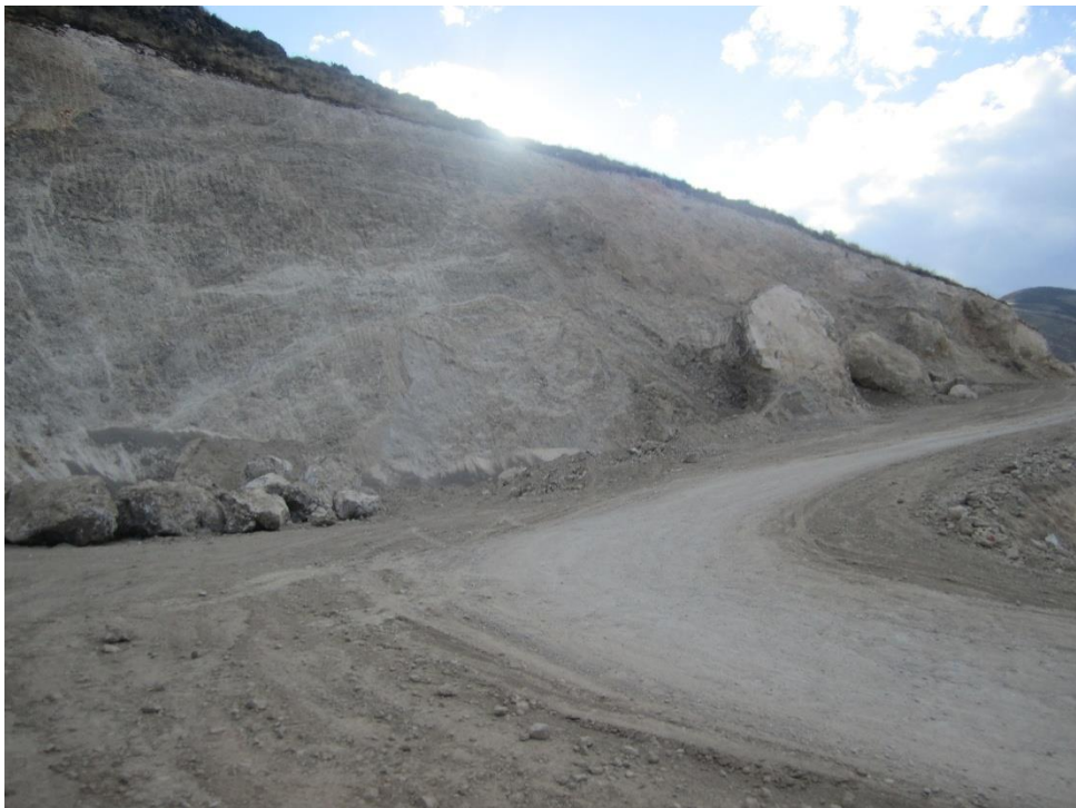
FOTOGRAFIA N° 10: Rocas dejados un peligro para la población y transportista
