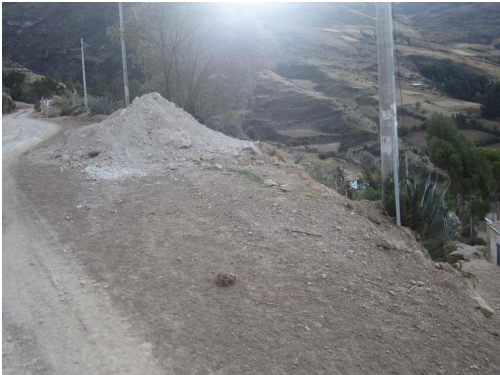
FOTOGRAFIA N° 12: Montículos de desmonte dejados que cae sobre la chacra y vivienda de los pobladores
