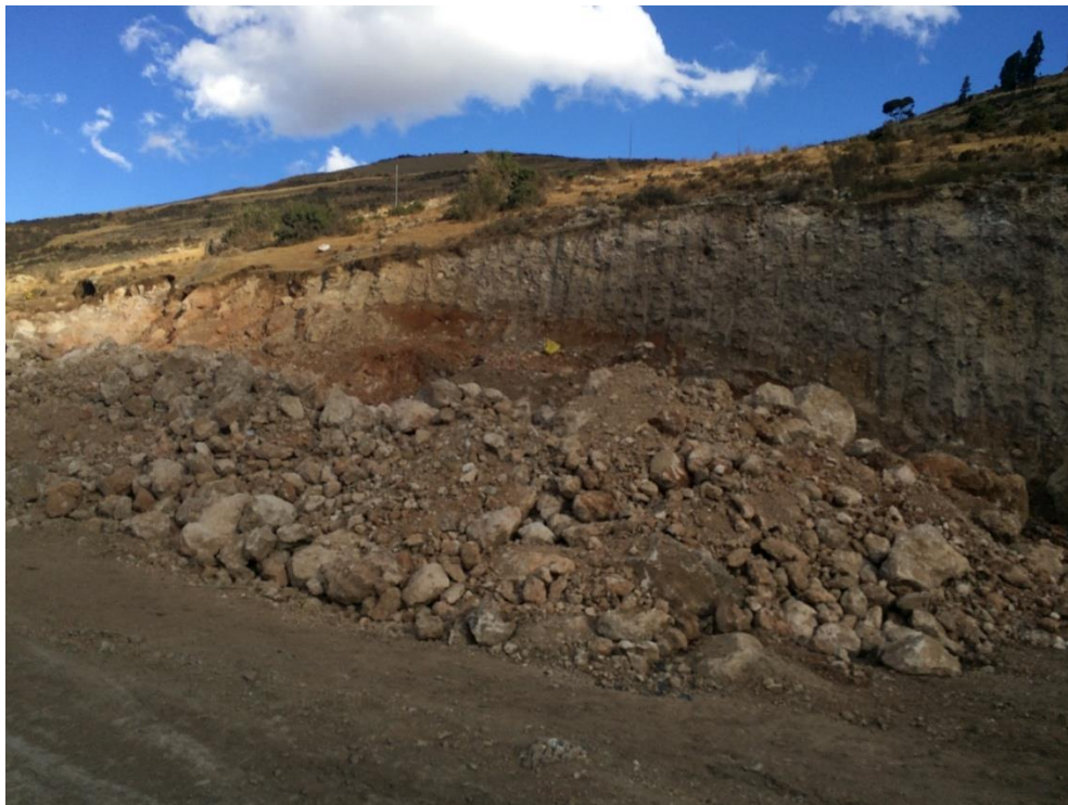
FOTOGRAFIA N° 4: Montículo de desmonte dejado sobre la carretera
