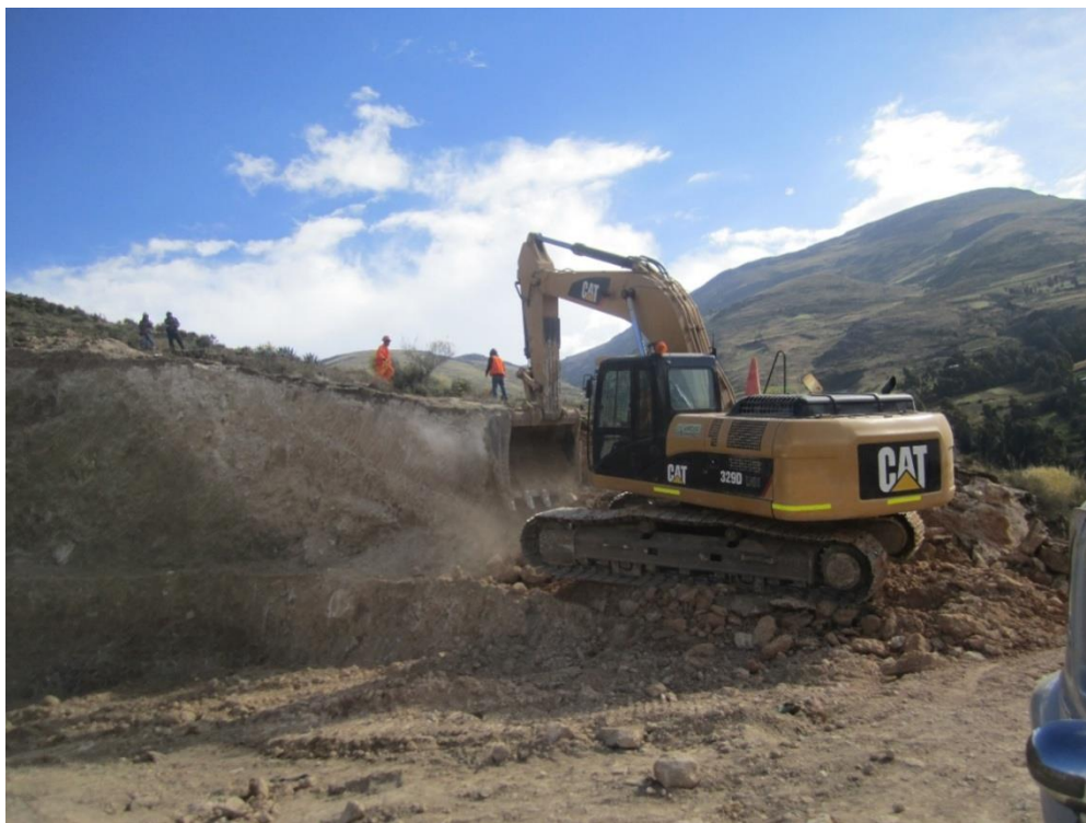
FOTOGRAFIA N° 2: En pleno trabajo de ensanchamiento y mejoramiento de la carretera y mucho polvo en el ambiente
