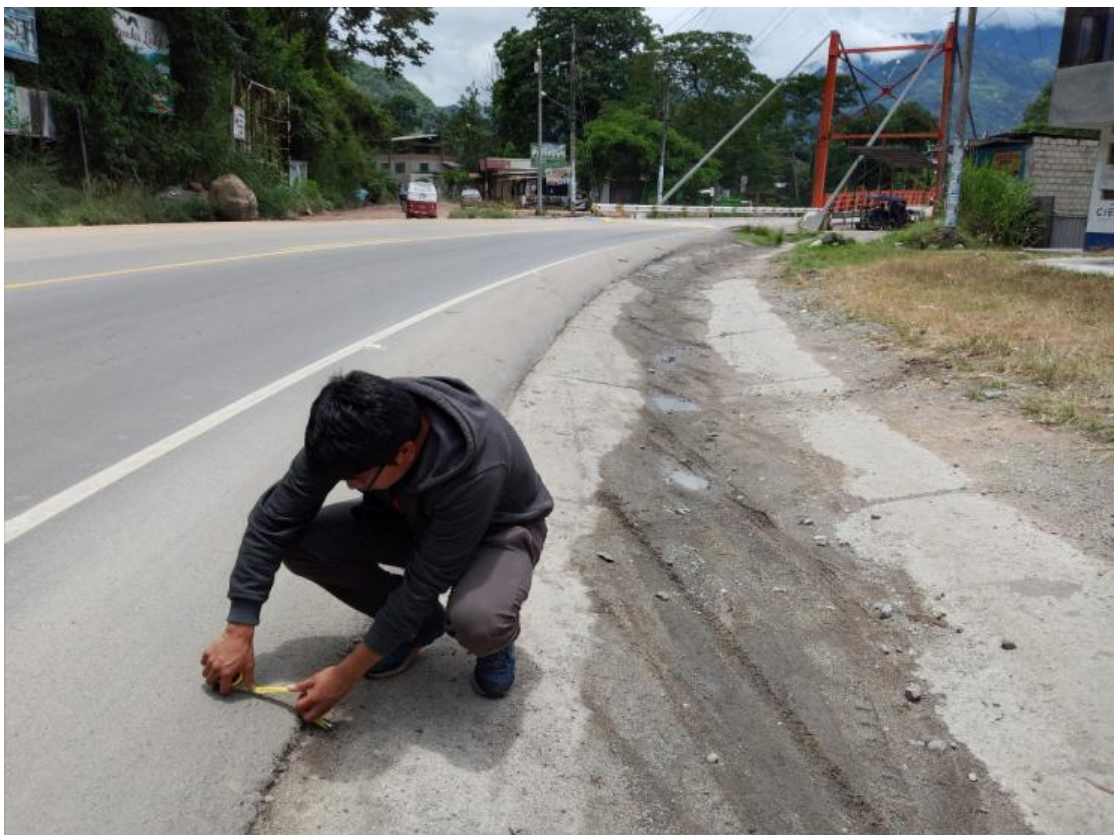
Fotografía 22. Vista de la carpeta asfáltica del tramo V de estudio.
