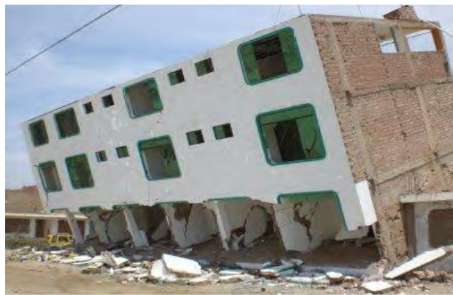
Figura N°7. Daño observado en las edificaciones luego del terremoto de Pisco del 15 de agosto del 2007.
