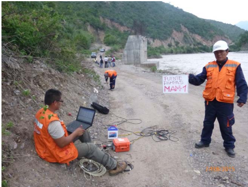
Fotografía 02: Sondaje MAM-01. Se puede apreciar el tendido de los cables.
