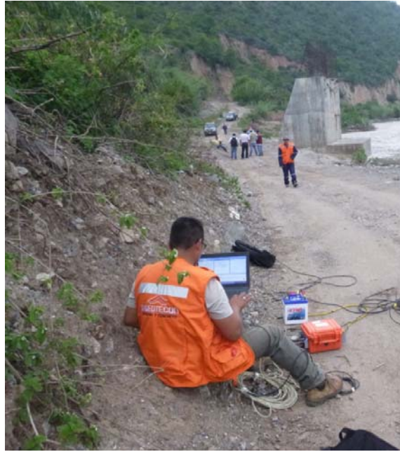
Fotografía 01: Zona de trabajo del Sondaje MAM-01. Se puede apreciar el tendido de cables.
