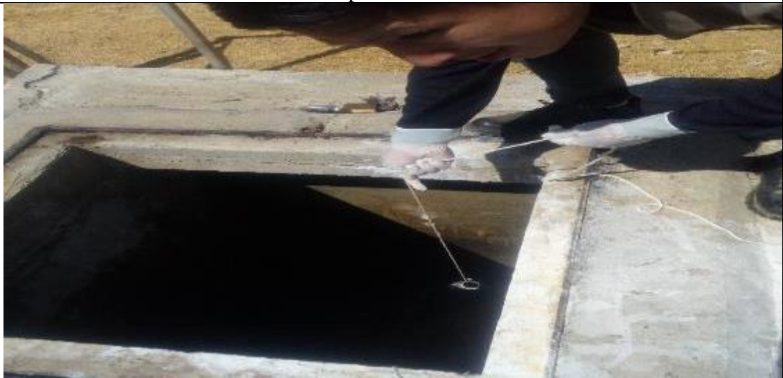
Cloración del agua del reservorio con el hipoclorador
