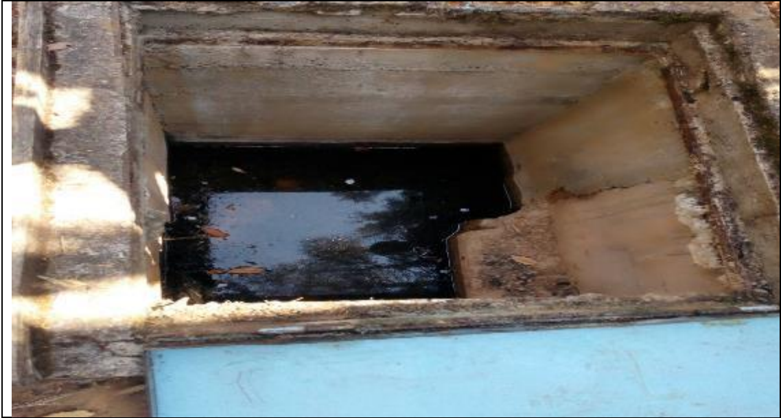
Caseta de Válvulas
