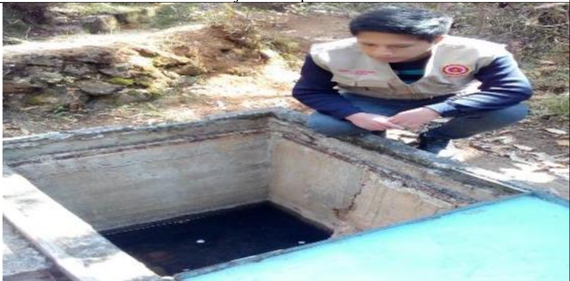
Identificación de la Caseta de Válvulas
