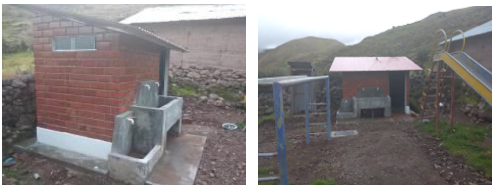
FIGURA N° 17 Se muestra las unidades básicas de saneamiento.
