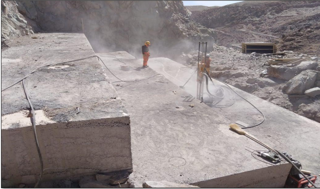
Imagen 9 Solado y perforaciones para inyección de agua cemento en pilar 2 FUENTE: Elaboración propia
