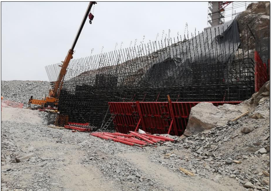
Imagen 10 Colocación de acero y encofrado en zapata de pilar 2 FUENTE: Elaboración propia
