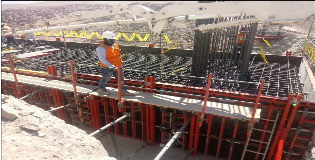
Imagen 5 Colocación de acero y encofrado en zapata de pilar 10 posterior a la terminación de los pilotes
