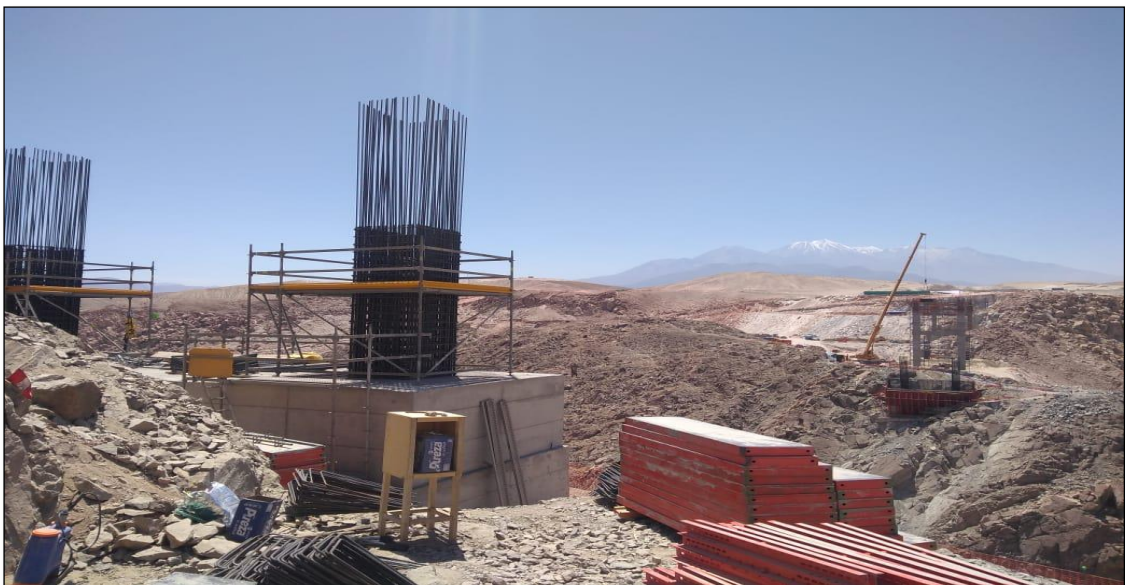
Imagen 6 Acero en columnas de pilar 1; se nos permitió traer encofrado trepante para realizar el tren de trabajo.
