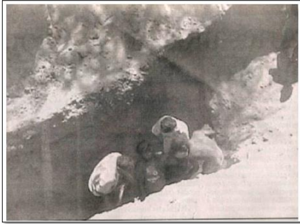
Figura 3 Dos obreros murieron por derrumbe de excavación de zanja de desagüe, el 26 de Setiembre del 2006, en Cayalti. El suelo era arenoso y la excavación era de 3m de profundidad. Tomado del diario "La Industria" de Chiclayo. Fuente: Rodríguez (2016)
