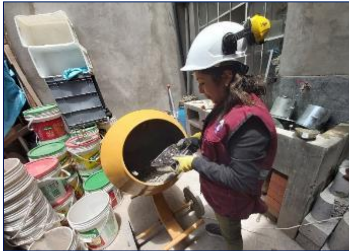
Fotografía 18. Proceso de mezclado del concreto con sustitución parcial del agregado fino por viruta de acero en 4 %.
