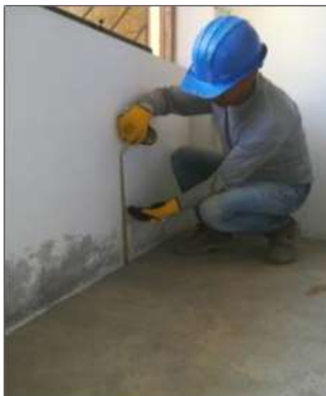
Ilustración 32. Medición de la zona afectada.
