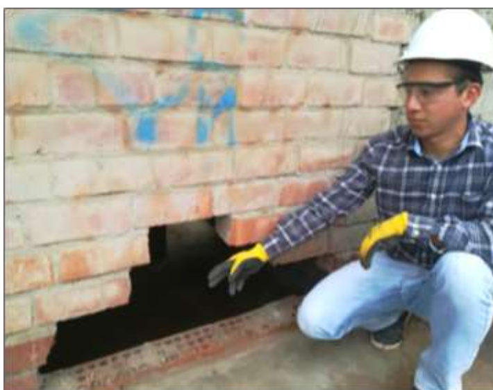
Ilustración 40. Se muestra el muro afectado con los ladrillos retirados.
