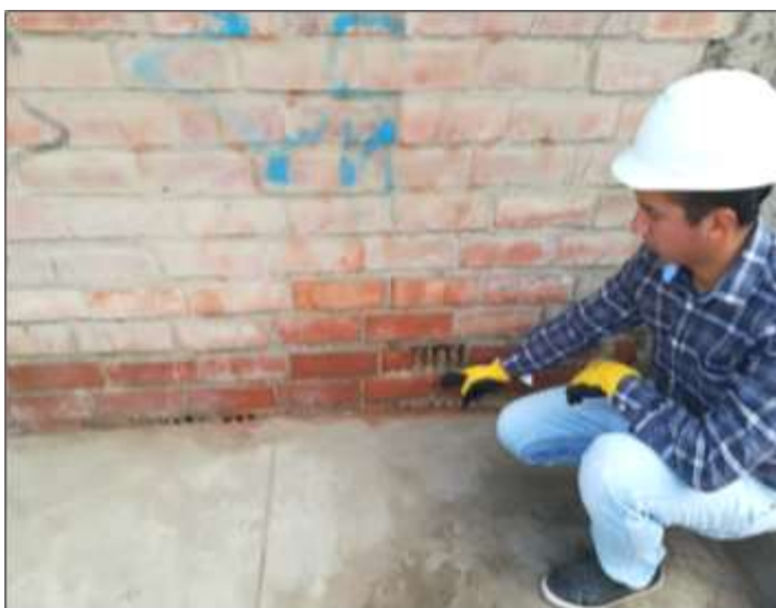
Ilustración 38. Ladrillos afectados por criptoflorescencia.
