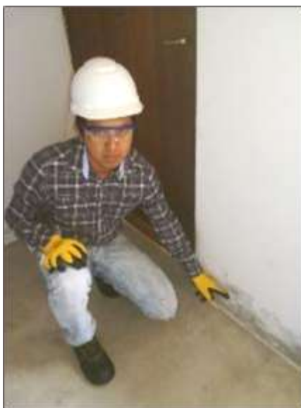
Ilustración 31. Zona inferior de muro afectado por eflorescencia.
