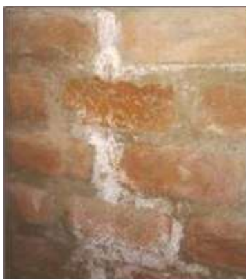
Ilustración 1. Eflorescencia en ladrillos.
