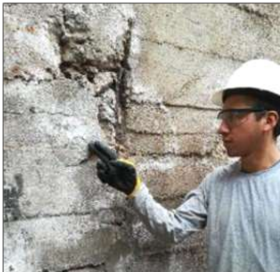
Ilustración 5. Eflorescencia en muro de concreto.
