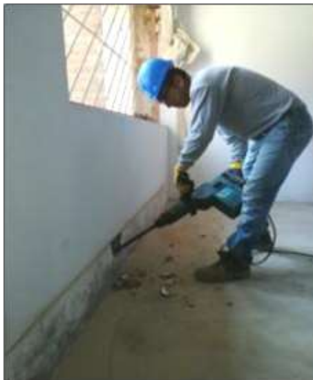
Ilustración 33. Retirando el revoque afectado por la eflorescencia.
