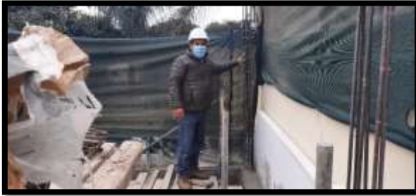
Fotografía 30: Confinamiento de estribos
