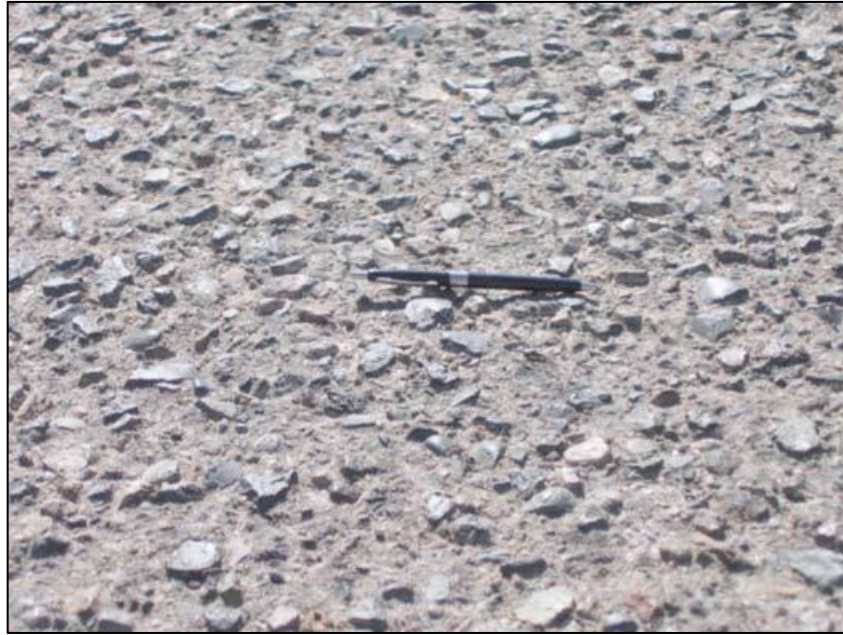
Figura 20: Desprendimiento de agregados de alta severidad Fuente: (ASTM Internacional , 2016)
