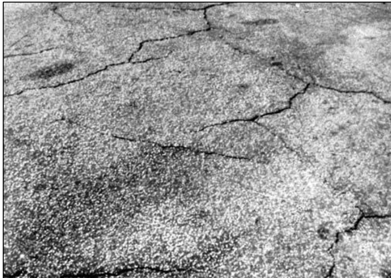
Figura 4: Agrietamiento en bloque de alta gravedad Fuente: (ASTM Internacional , 2016)
