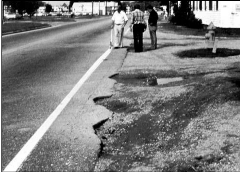
Figura 8: Grieta de borde de alta gravedad Fuente: (ASTM Internacional , 2016)
