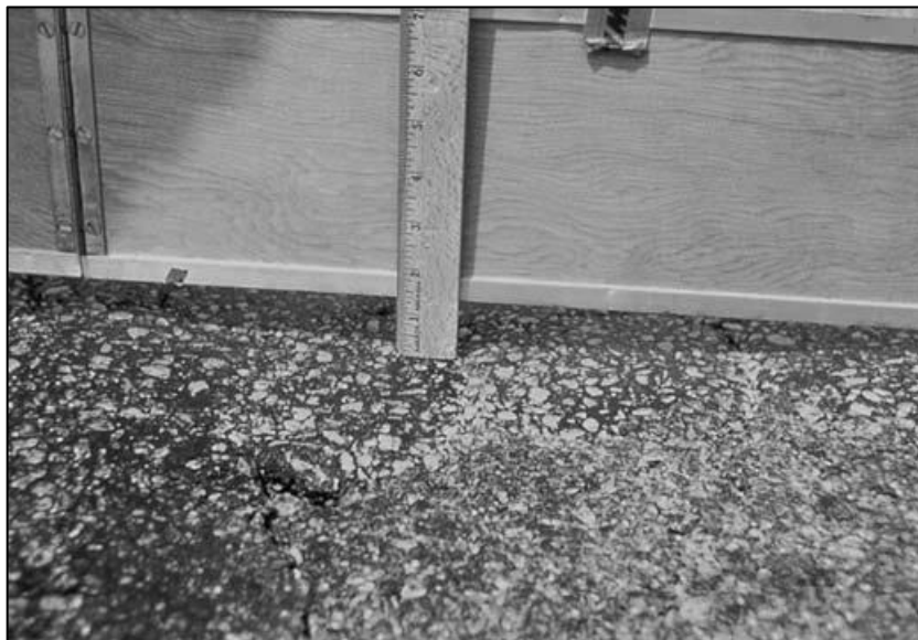
Figura 16: Ahuellamiento de alta gravedad Fuente: (ASTM Internacional , 2016)
