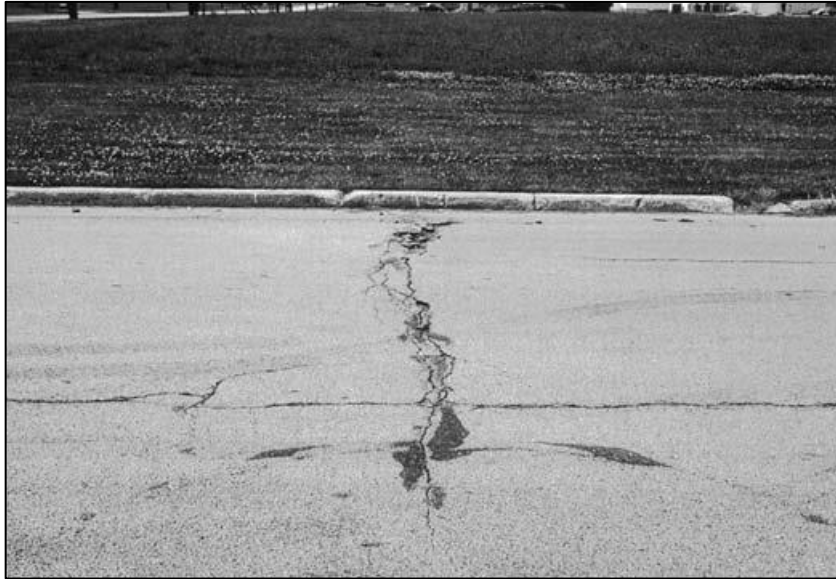
Figura 11: Grietas longitudinales y transversales de alta gravedad Fuente: (ASTM Internacional , 2016)
