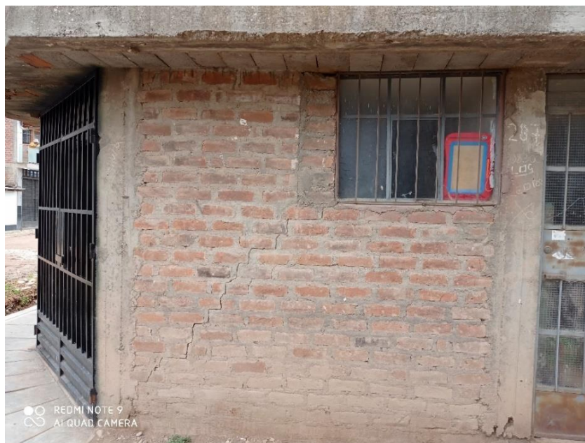
Figura 2: Falla por corte de una vivienda en el Distrito de El Tambo
