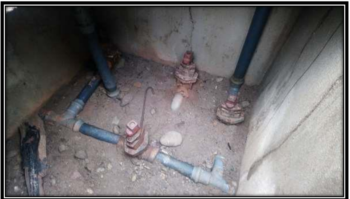
Fotografia Nro.6 revicion de la camara de valvulas en el reservorio.
