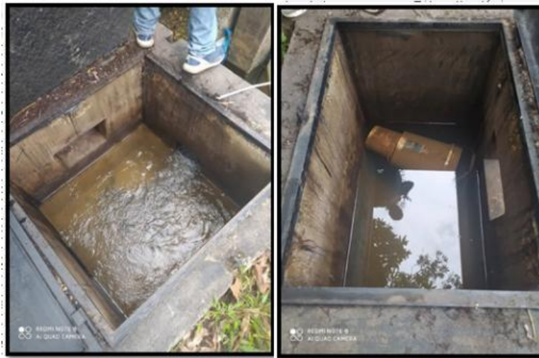
Figura 26 Observar el mas estado en que se encuentran las cajas de rebose, presentan obstrucción,
