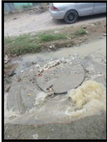
Figura 33 Buzones descubiertos por la erosión del suelo generando malos olores.
