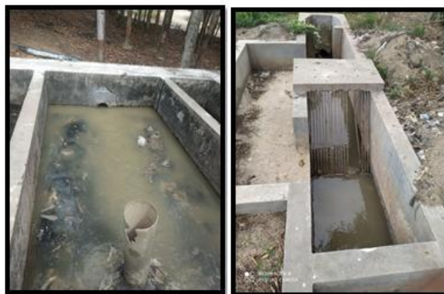
Figura 40 Estado inoperativo de las lagunas facultativas y Cámara de rejillas oxidadas y defectuosas dejando el paso de materiales a la laguna.
