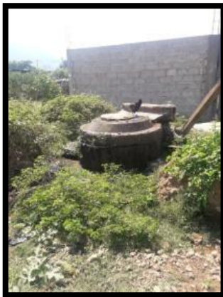
Figura 34 Tuberías obstruidas por la presencia de arena, que no permita la buena circulación de las aguas residuales.
