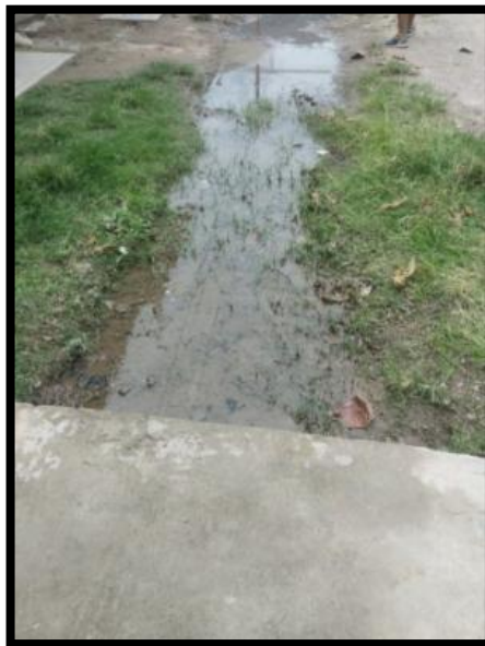
Figura 31 Ffiltración de agua
