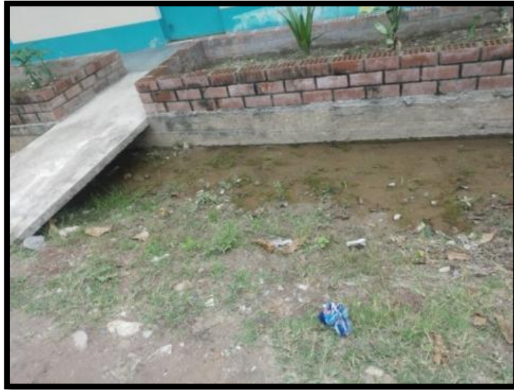
Figura 30 Tuberías rotas en algunos tramos, presentan filtración de agua.
