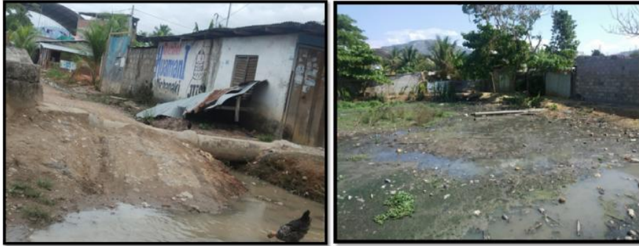
Figura 36 Tuberías con fisuras formado charcos de aguas residuales erosionando las calles y formación de lagunas en los puntos con bajo pendiente debido al colapso de buzones.
