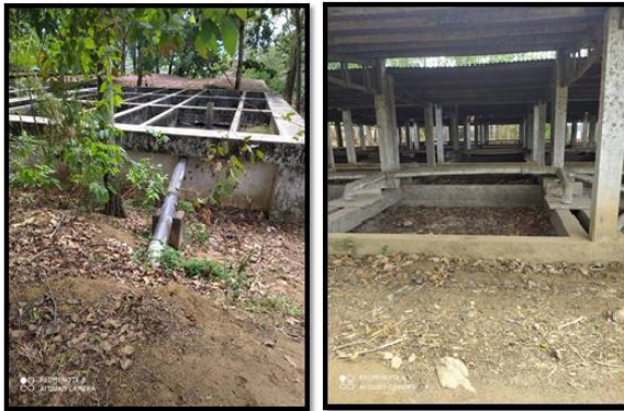
Figura 38 La planta de tratamiento abandonado invadido de arbustos y árboles y la Infraestructura con fisuras con peligro de colapso en tiempo de lluvias.
