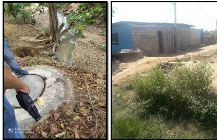
Figura 37 Buzones sin conexiones dejando pasar las aguas residuales.
