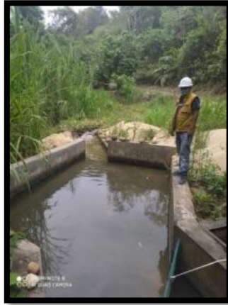
Figura 24 Poco mantenimiento de las compuertas con partes rotas no filtrando bien el agua.
