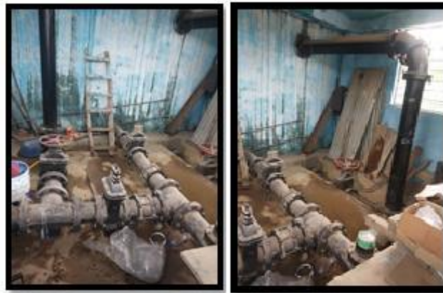
Figura 29 Imagen de los de las tuberías del reservorio
