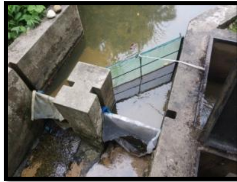
Figura 25 Caja de recolección sin mantenimiento con paredes sucias y compuertas oxidadas.
