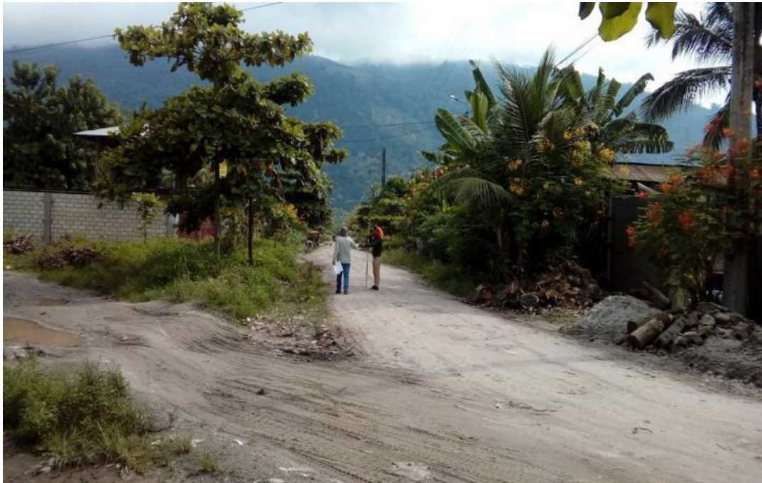
SE OBSERVA DONDE EL INGENIERO PROYECTISTA MARCA LOS PUNTOS PARA LA TOMA DE DATOS
