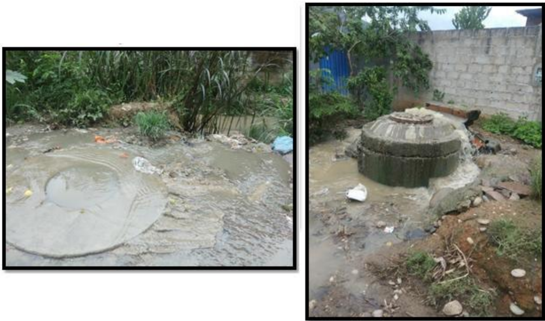
Figura 32 Los buzones colapsados formado riachuelos de aguas residuales impediendo el tránsito de las personas.
