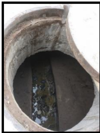
Figura 35 Tuberías descubiertas impidiendo el tránsito de vehículos y personas.
