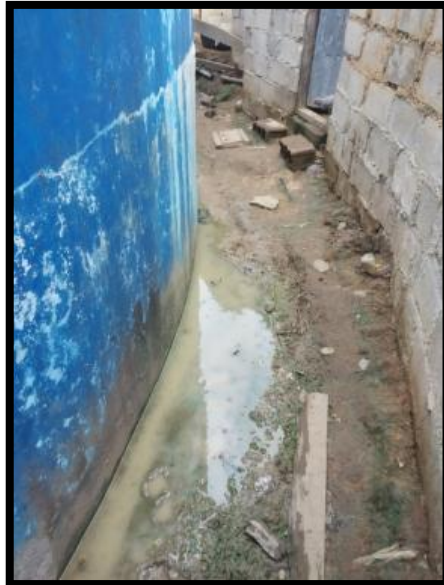
Figura 27 Cimientos agrietados dejando filtrar agua, contaminando su contenido.
