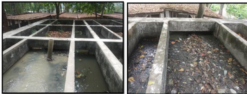
Figura 39 Lecho de secado en mal estado, sin funcionamiento y Planta biológica colapsado y abandonado.
