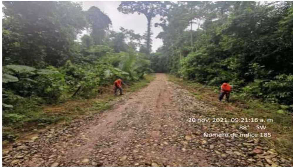
Figura N° 03: Carpeta de afirmado en malas condiciones de transitabilidad
