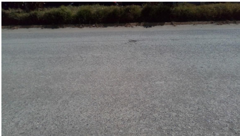
TIPO DE FALLA. Pulimiento de Agregados Huecos Severidad: Media
