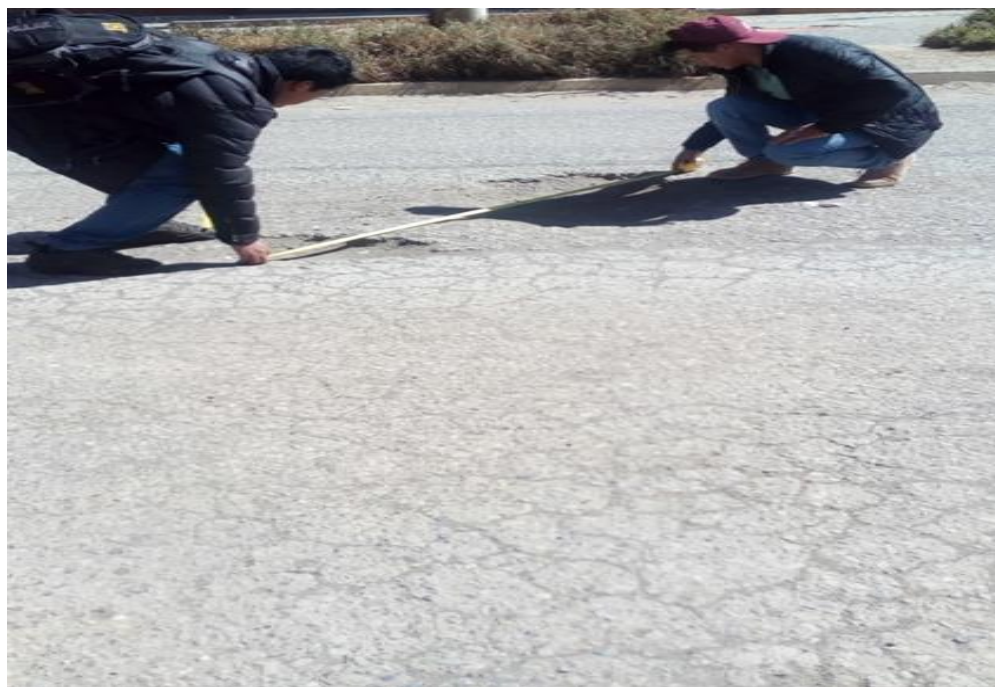
TIPO DE FALLA. Huecos y Piel de cocodrilo Severidad: Alta
