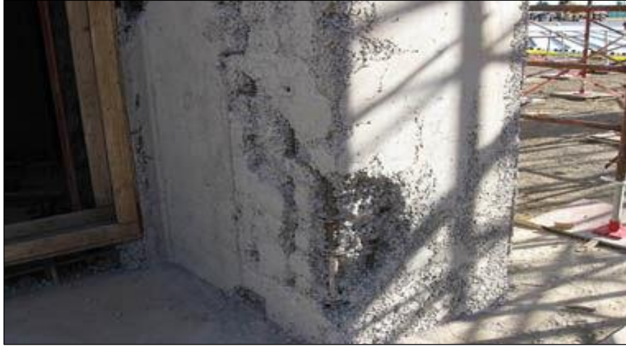
Figura 1. Vista de las Cangrejeras producidas por un mal colocado del concreto.
