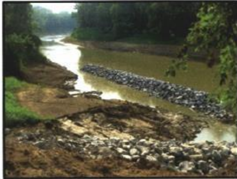
Figura 3 Dique longitudinales construido con roca Fuente: http://es.wikepeia.org/wiki .
