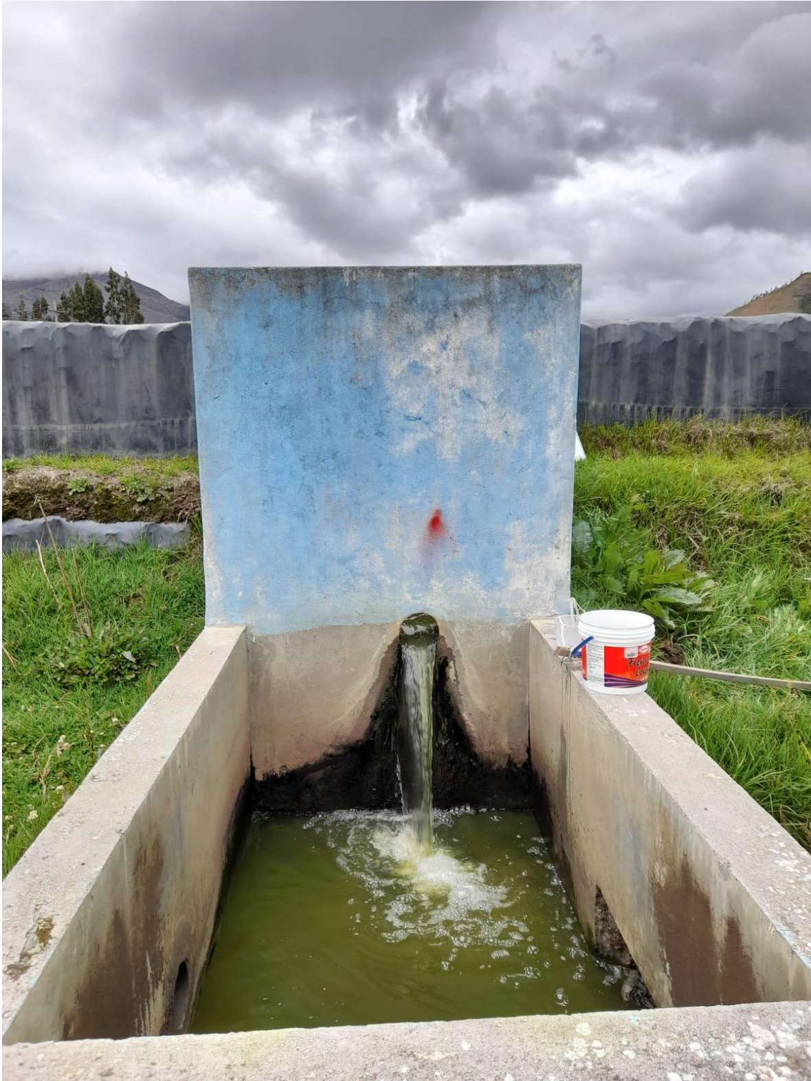
Fotografía 3: Salida del agua residual tratada de la laguna de estabilización.
