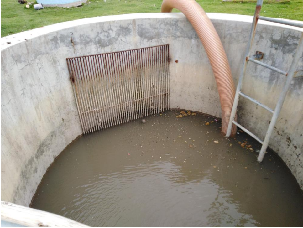
Fotografía 1: Pozo de gruesos de la PTAR de Ahuaycha colapsado.
