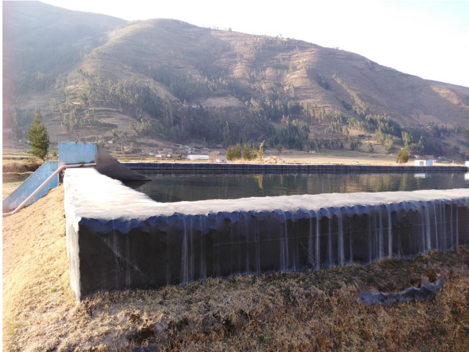
Fotografía 7: Laguna de estabilización.
