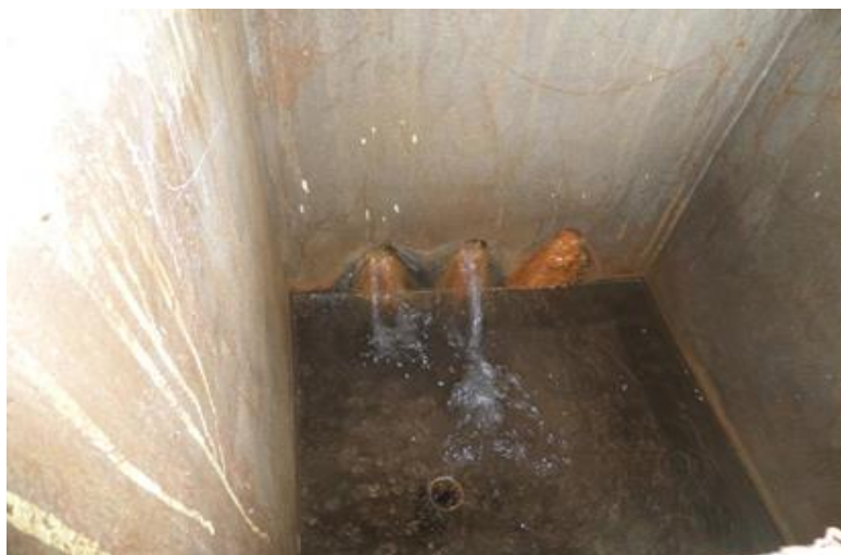
Imagen 8: Captación subterránea existente pucullo.
