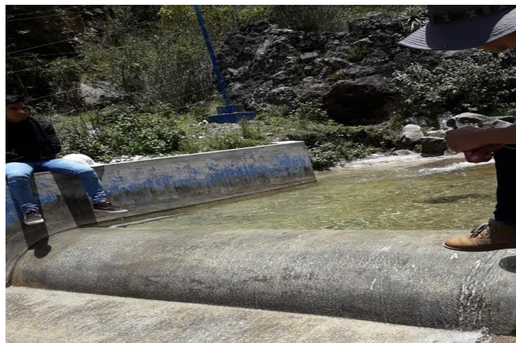
Imagen 11: Captación superficial Chiccyahuaycco.
