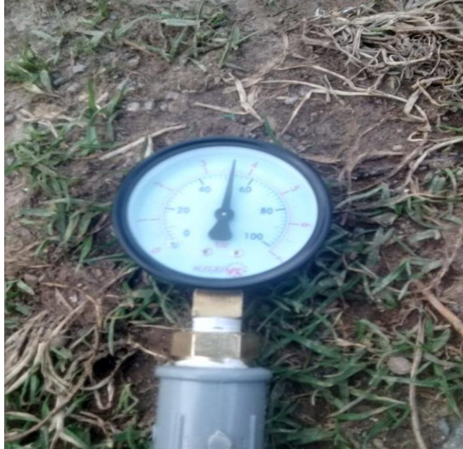
Imagen 25: Vista de la medición registrada en el manómetro.
