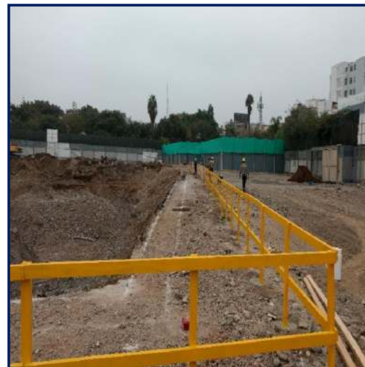
Figura 29. Barandas de protección.
