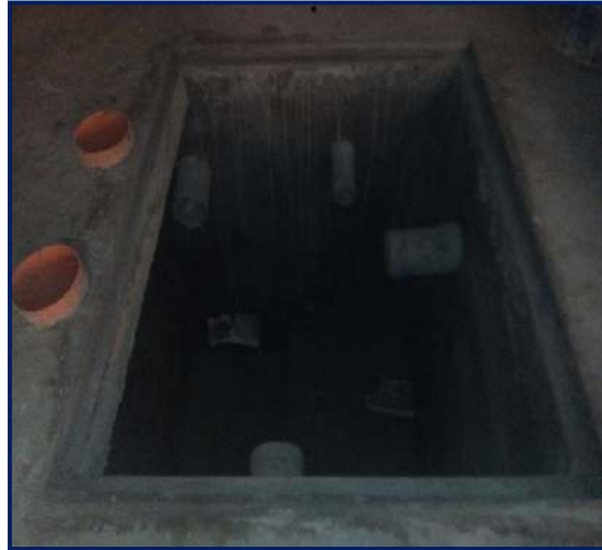
Figura 150. Pozo sumidero Fuente: propia
