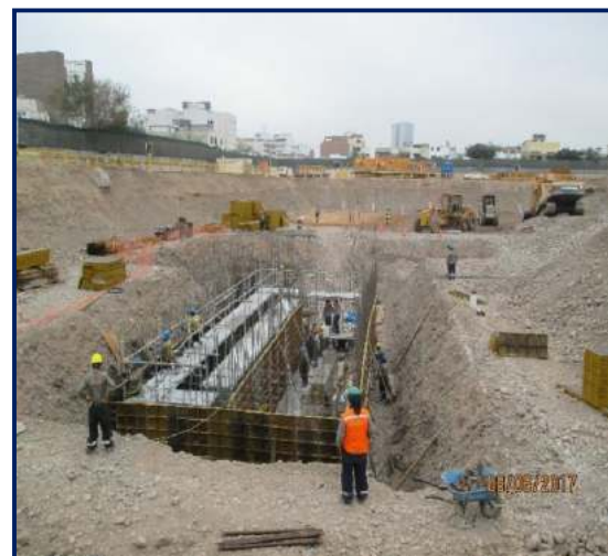
Figura 55. Verticales en Cisterna. Fuente: propia
