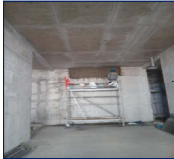
Figura 113. Solaqueo en sótanos. Fuente: propia
