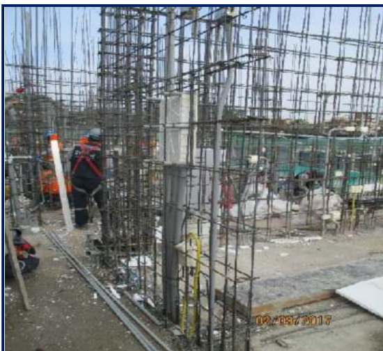
Figura 78. Instalaciones en Torre C. Fuente: propia
