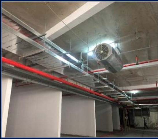
Figura 155. Jet fan en sótano IIMM. Fuente: propia
