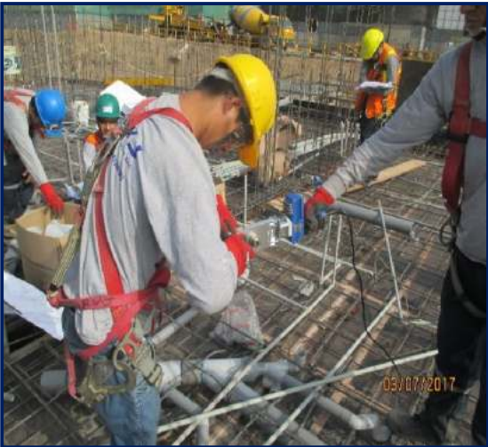
Figura 68. Instalaciones en losa. Fuente: propia
