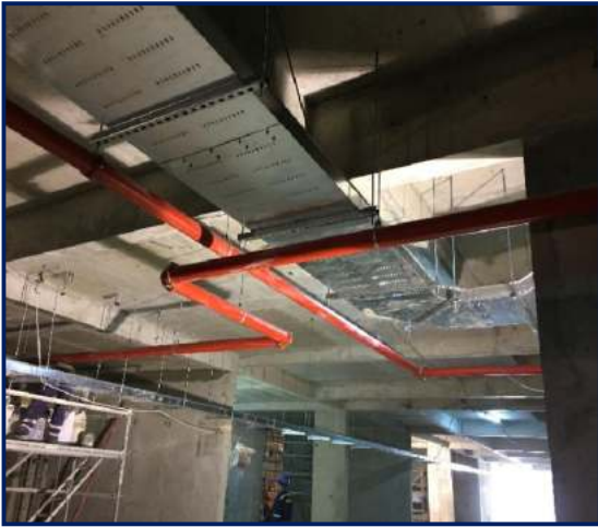
Figura 139. Instalaciones de ACI. Fuente: propia
