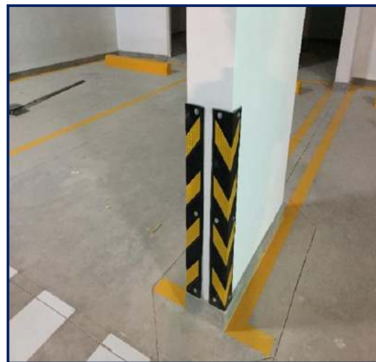
Figura 162. Protección en columnas.
