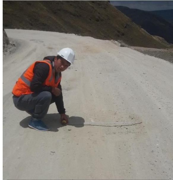
Ahuellamiento de la Carpeta de rodadura del Tramo Prog. 00+ 550 km
