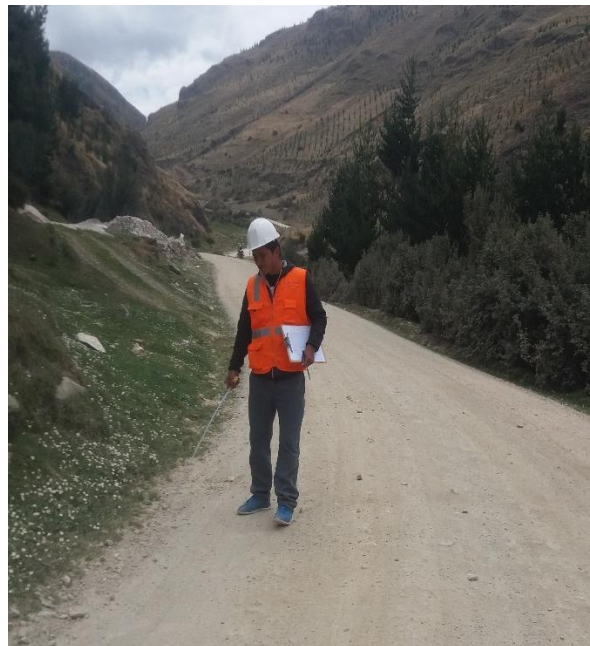
El Tramo no cuenta con Drenaje Lateral
