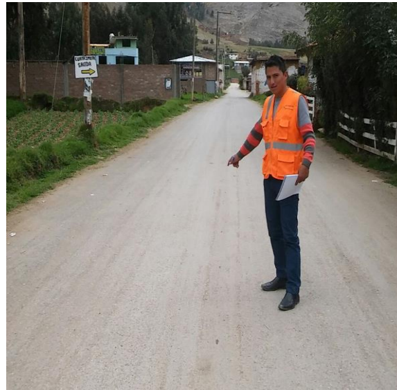
Tramo de la Carretera de Ñawinpuckio ha sido ejecutado en el año 1995, Pro. 04+00km
