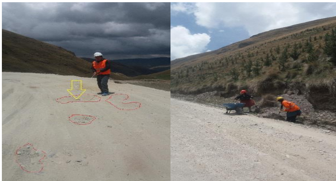
Figura N°01: Estado situacional de la vía en estudio.
