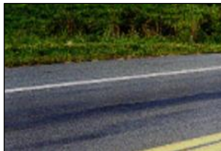
Figura 7. Exudaciones en pavimentos asfálticos
