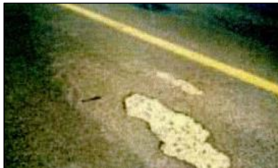
Figura 8. Segregación en un pavimento asfaltado
