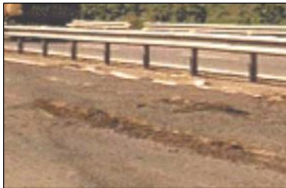
Figura 9. Desplazamiento en pavimento asfaltado.
