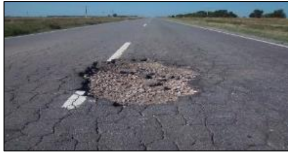
Figura 15. Fisuramiento en asfalto
