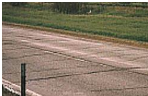
Figura 11. Agrietamientos y Fisuras
