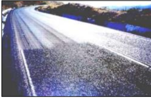
Figura 10. Desplazamiento en pavimento asfaltado.
