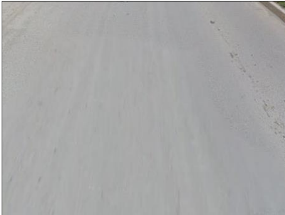
Figura 51. Ahuellamiento en el carril derecho Av. Huancavelica progresiva 0+153.2–0+191.5
