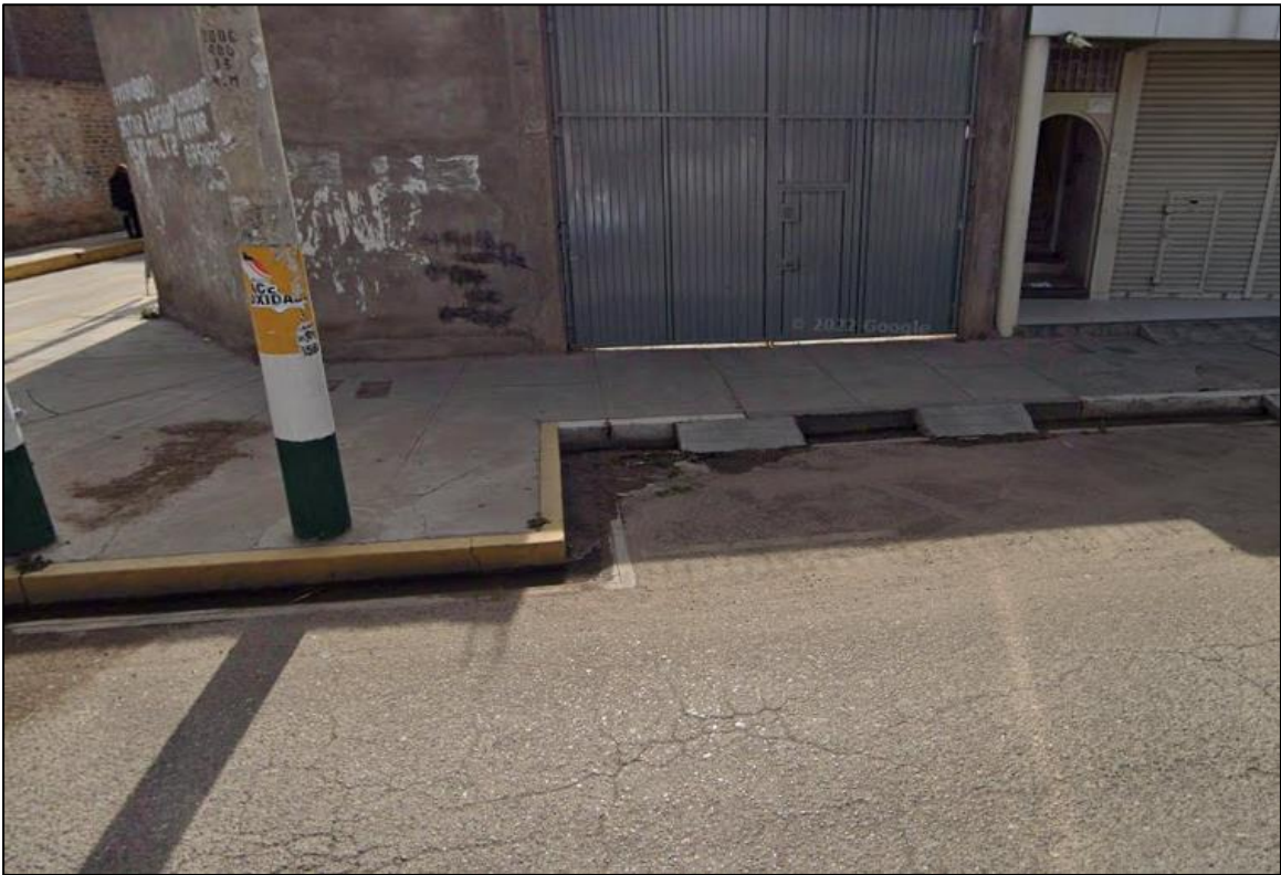
Figura 4. Cunetas saturadas por lodo.
