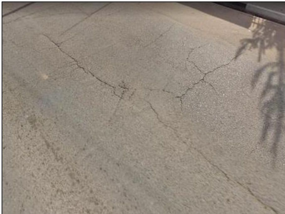
Figura 42. Agrietamiento en bloque y grietas longitudinales en el carril izquierdo Av. Huancavelica progresiva 0+344.7 – 0+383.0
