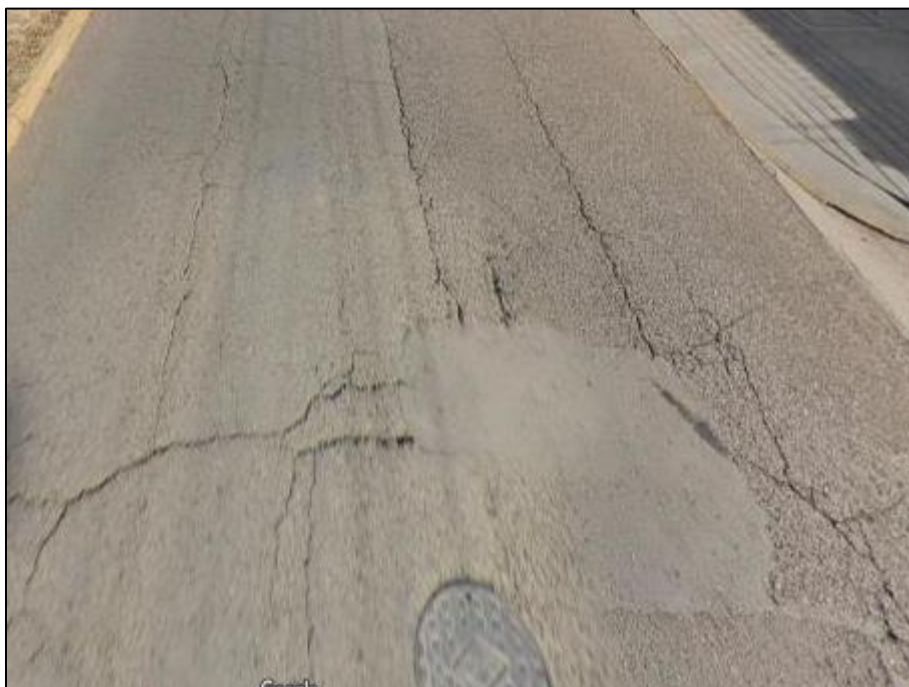
Figura 40. Grietas longitudinales y transversales en el carril izquierdo Av. Huancavelica progresiva 0+612.8- 0+651.1
