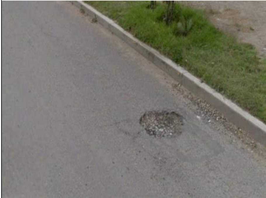
Figura 57. Bache o hueco en el carril derecho Av. Huancavelica progresiva 0+229.8 – 0+268.1
