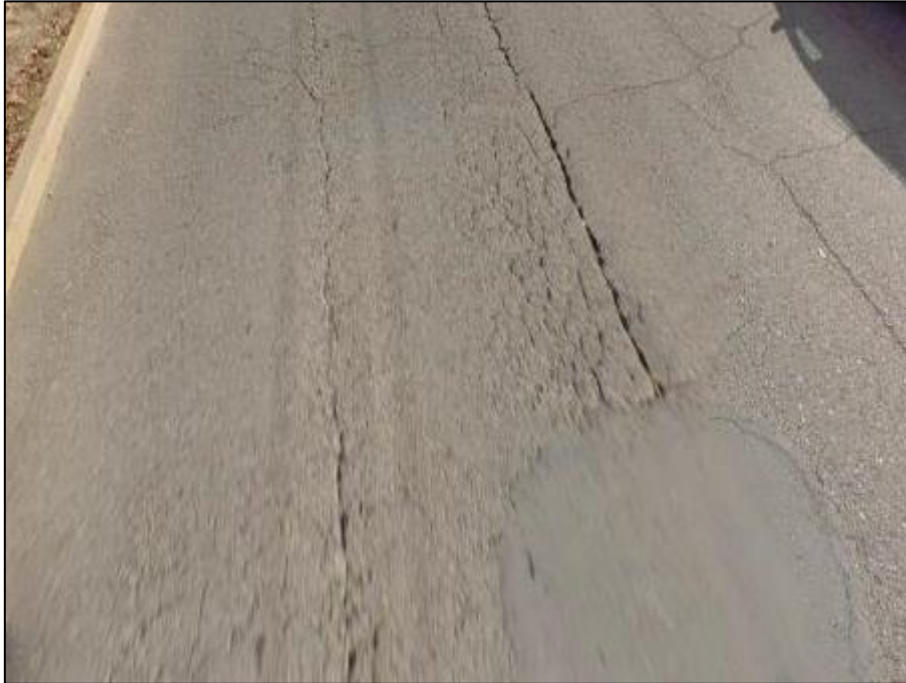
Figura 43. Parches, grietas longitudinales y piel de cocodrilo en el carril izquierdo Av. Huancavelica progresiva 0+268.1 – 0+306.4
