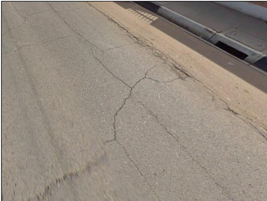
Figura 44. Agrietamiento en bloque en el carril izquierdo Av. Huancavelica progresiva 0+268.1 – 0+306.4
