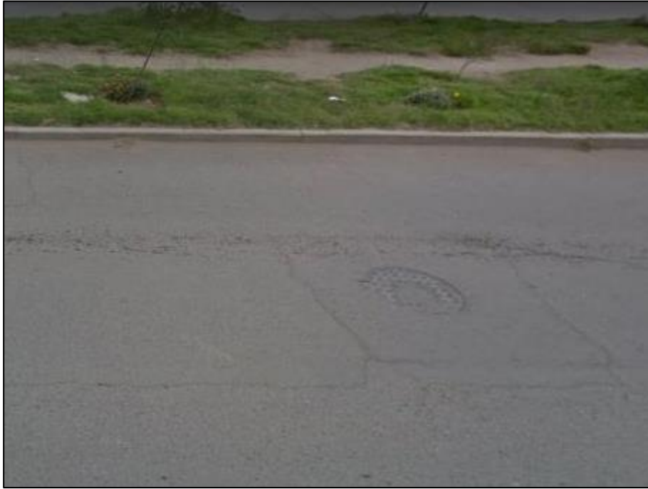
Figura 47. Parches en el carril izquierdo Av. Huancavelica progresiva 0+038.3 – 0+076.6
