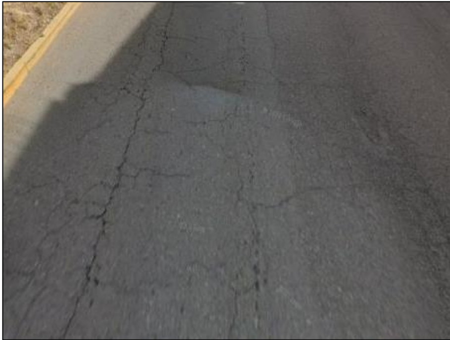
Figura 39. Grietas longitudinales y piel de cocodrilo en el Carril Izquierdo Av. Huancavelica progresiva 0+612.8- 0+651.1
