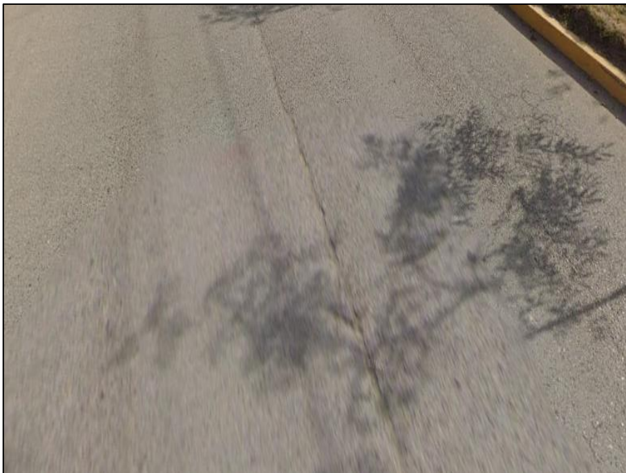
Figura 56. Grietas longitudinales y ahuellamiento en el carril izquierdo Av. Huancavelica progresiva 0+536.2 – 0+574.5
