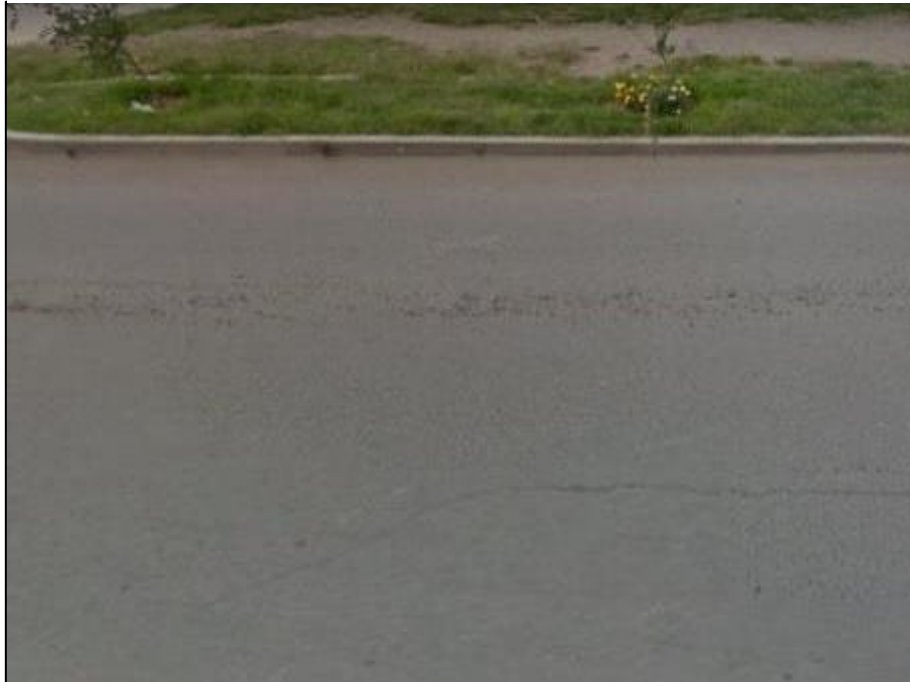
Figura 48. Grietas longitudinales y transversales en el carril izquierdo Av. Huancavelica progresiva 0+038.3 – 0+076.6
