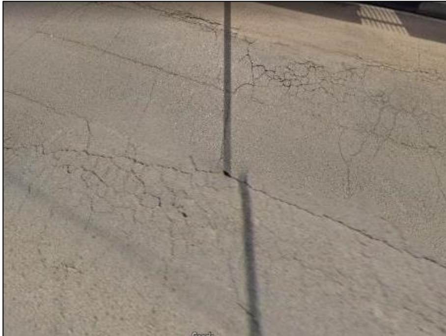
Figura 41. Agrietamiento en bloque y piel de cocodrilo en el carril izquierdo Av. Huancavelica progresiva 0+344.7 – 0+383.0
