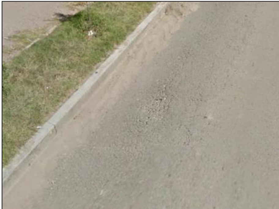
Figura 58. Piel de cocodrilo en el carril derecho Av. Huancavelica progresiva 0+612.8 – 0+651.1
