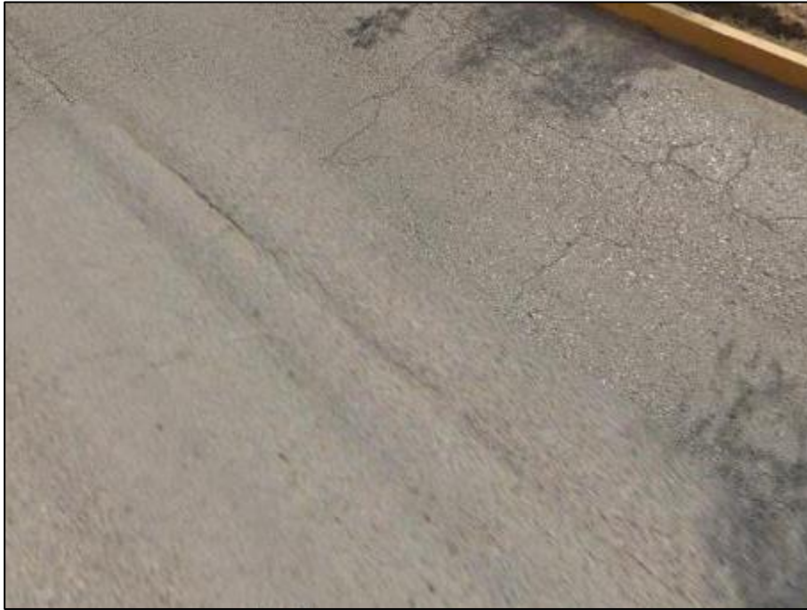
Figura 53. Ahuellamiento bloque y agrietamiento en bloque en el carril derecho Av. Huancavelica progresiva 0+344.7 – 0+383.0
