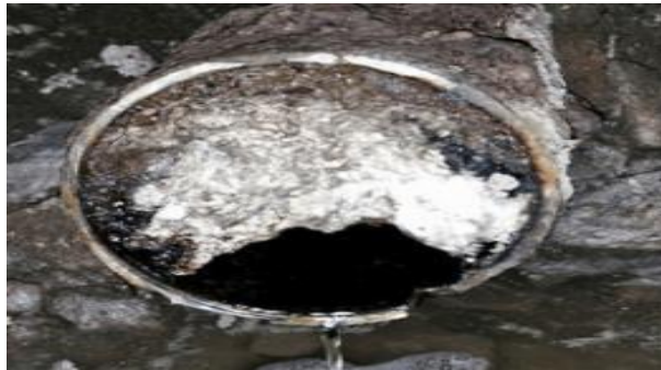
Figura 3. Gráfico de acumulación de grasas en la tubería
