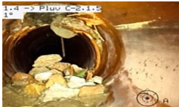
Figura 5. Obstrucción a causa de trapos, plásticos y vidrio en la tubería
