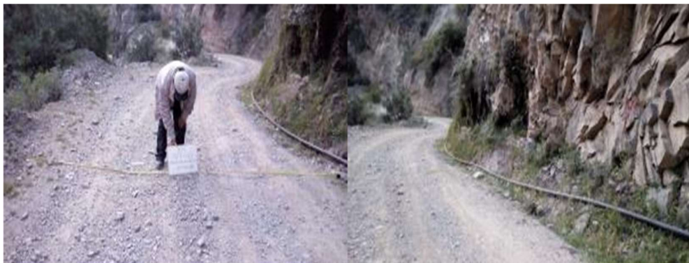
Ancho de Plataforma y la vía en mal estado (ahuellamientos) en el Km. 1+000
