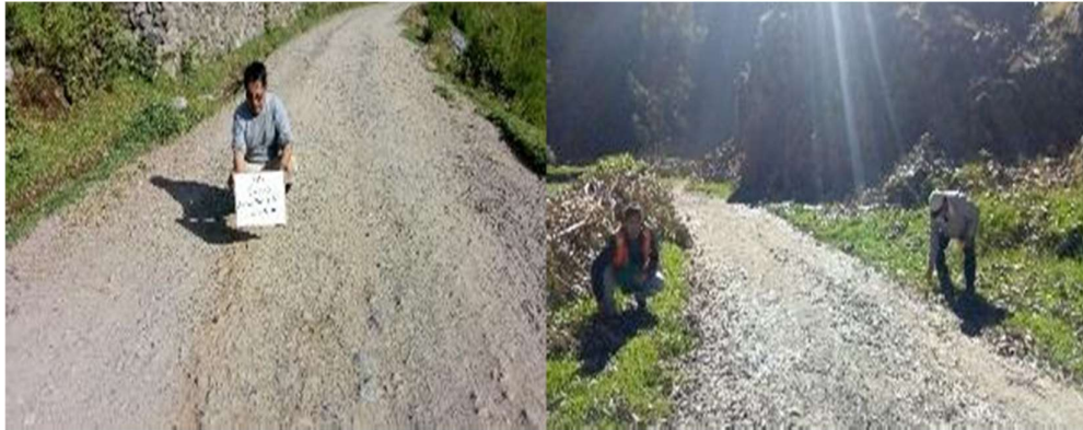
Suelo deformado con ahuellamientos y baches en el Km. 9+000 y Km. 09+240
