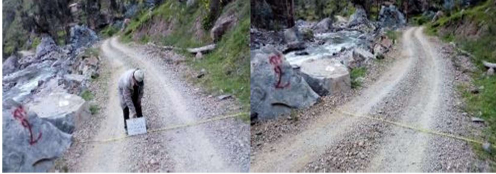
Ancho de Plataforma y la vía presenta ahuellamientos en el Km. 2+000
