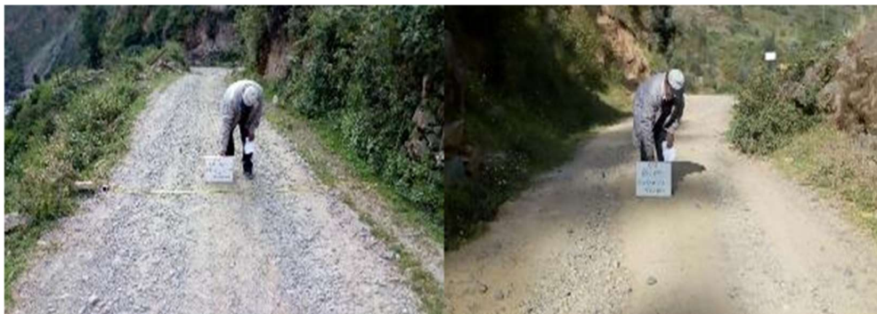
Ancho de plataforma y suelo deformado con ahuellamiento y baches en el Km. 5+000 y Km. 6+000
