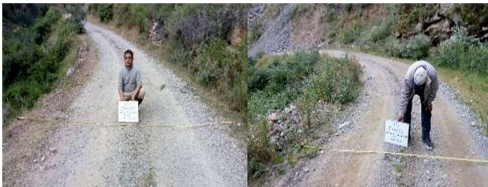
Ancho de plataforma y presencia de Baches en el Km. 3+000 y Km. 4+000
