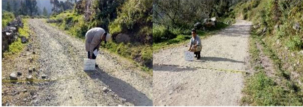
Suelo deformado con ahuellamientos y baches en el Km. 7+000 y Km. 8+000
